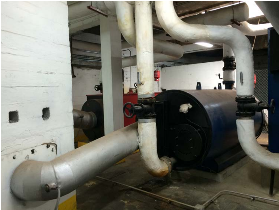
Foto 4: Caldera 1: circuito de agua caliente, valvulería y salida de humos.
