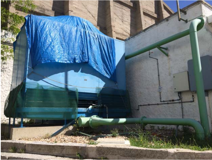
Foto 11: Torre de refrigeración.
