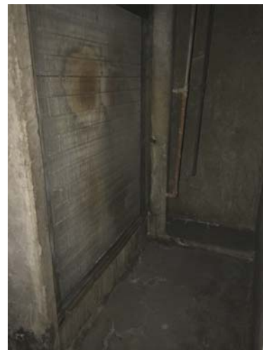
Foto 25: Interior del climatizador.
