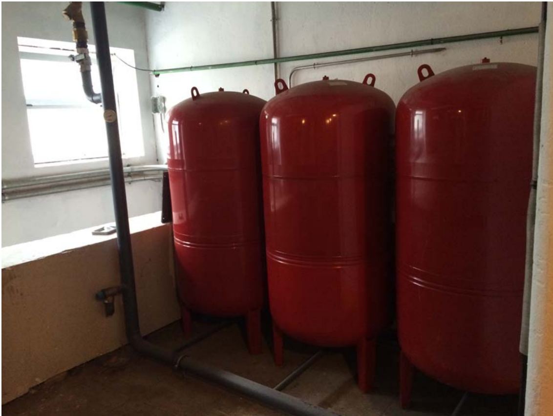
Foto 6: Vasos de expansión para calefacción, de posterior colocación.
