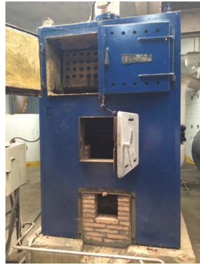
Foto 2: Caldera antigua en desuso.
