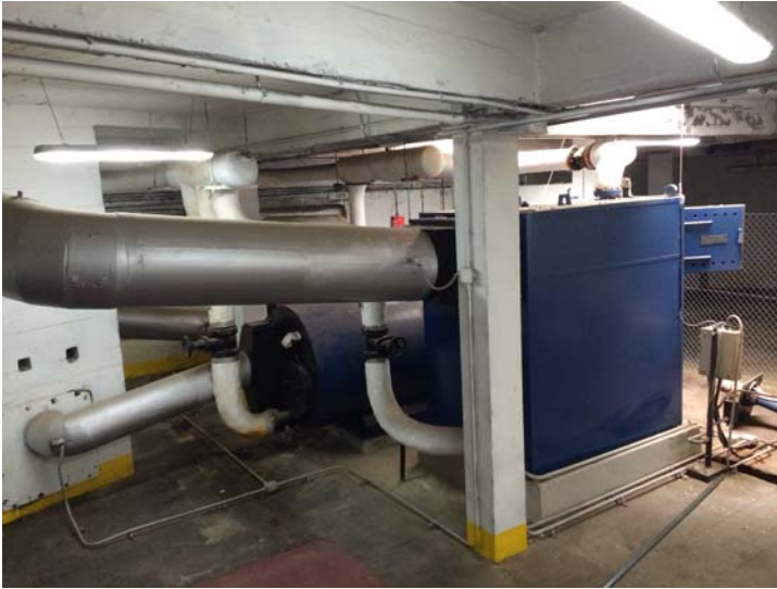
Foto 1: Calderas en la sala.
