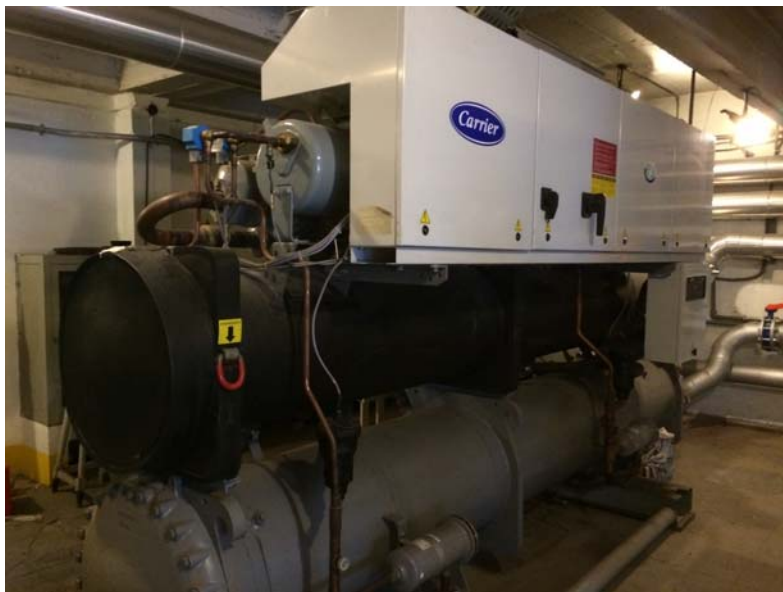
Foto 14: Planta enfriadora, de incorporación posterior a la instalación.
