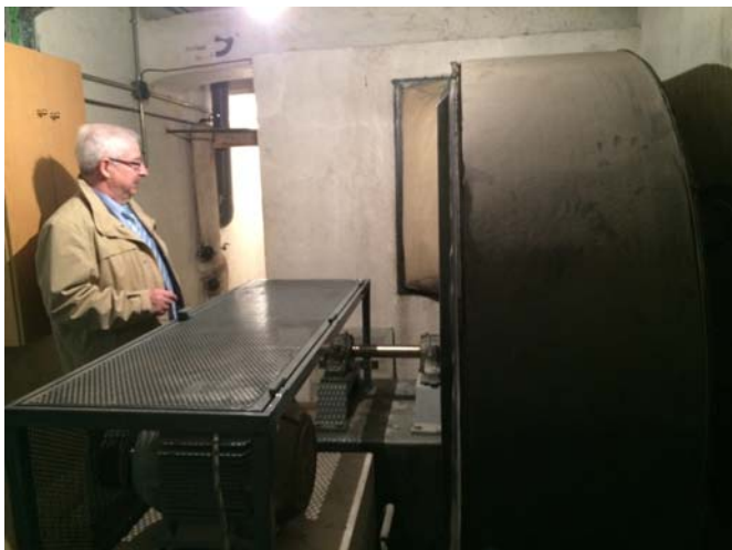
Foto 24: altura relativa del climatizador. Turbina.
