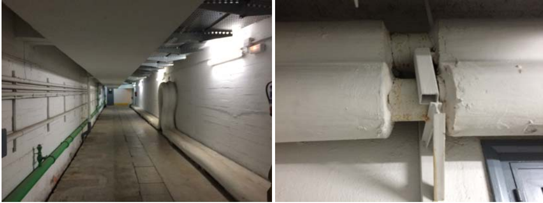
Foto 20: Trazado del circuito de transporte (hidráulico) por el sótano del edificio.
