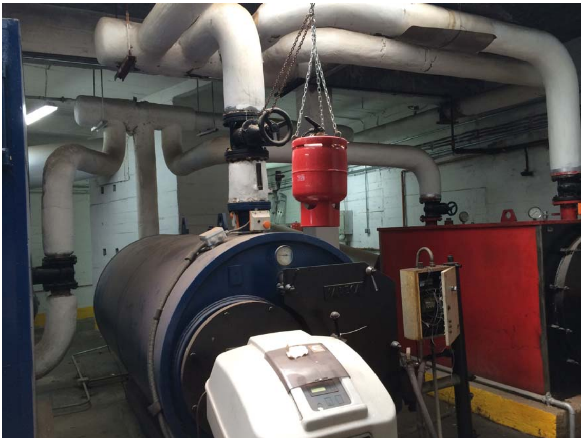
Foto 3: Calderas en uso, con gasóleo. Circuito de agua caliente, valvulería y extintor.
