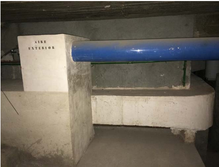
Foto 34: Toma de Aire Exterior para climatizador.
