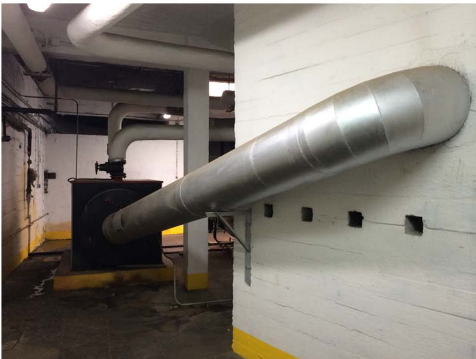
Foto 5: Caldera 2: circuito de agua caliente, valvulería y salida de humos.
