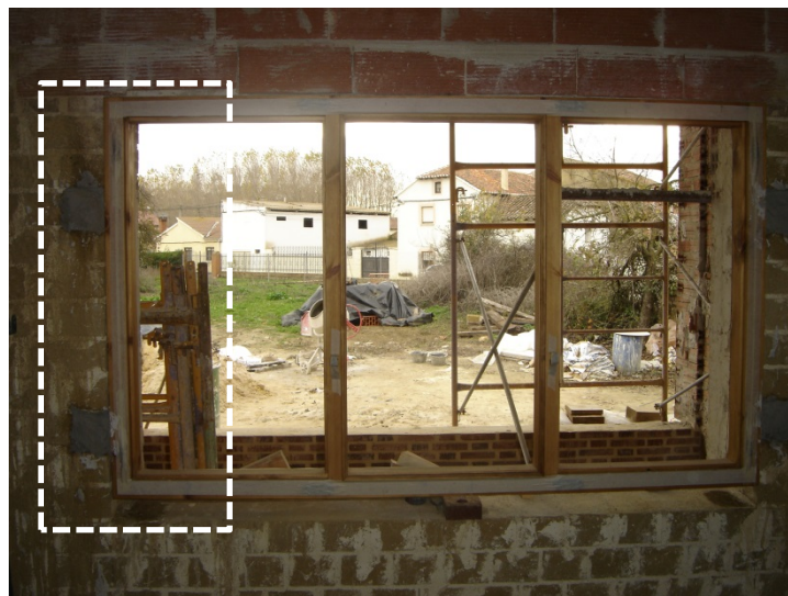
Figura 36. Premarco con anclaje a las jambas. Fuente: Jon Santibáñez y propietario del inmueble.
