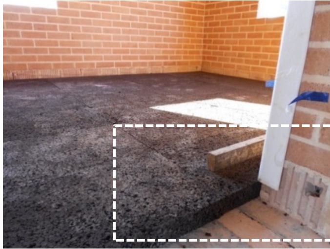
Figura 30. Elevación del muro por medio de bloques cerámicos. BAL-001. Fuente: Eduardo Ramos (Ecocreamos).
