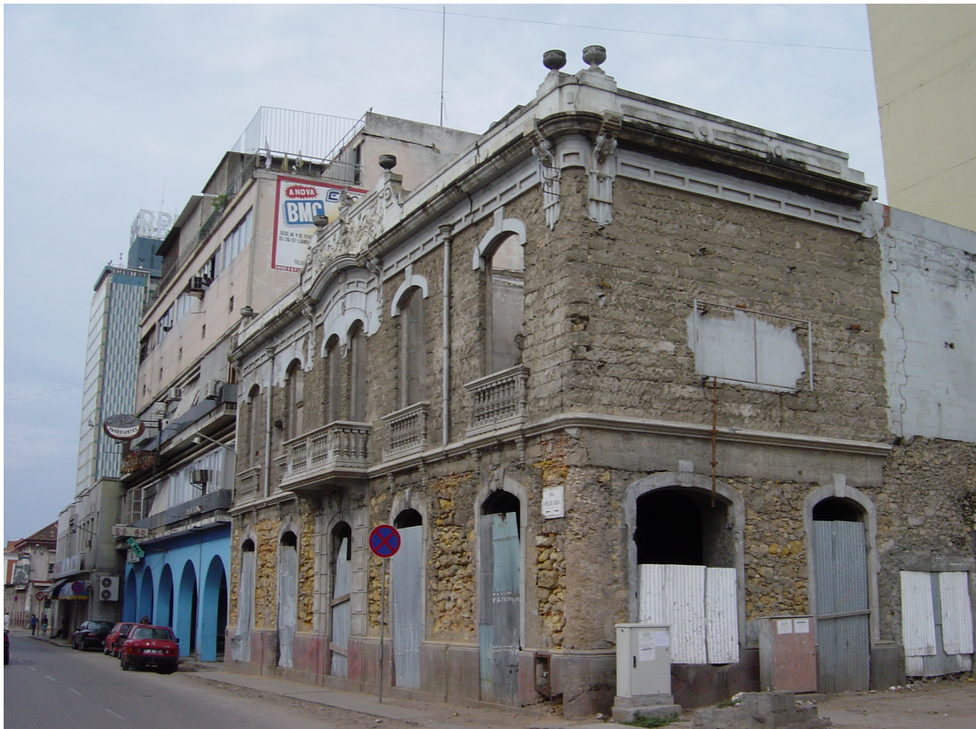
Fig. 47 – Rua Rainha Ginga - Vista de um edifício em estado de degradação
