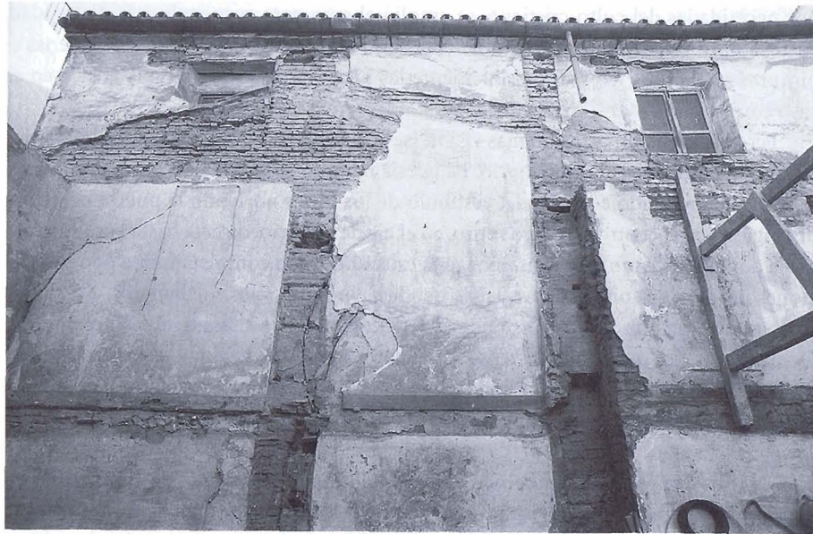
FIG. 13. Rastro de arco en el muro de la iglesia.
