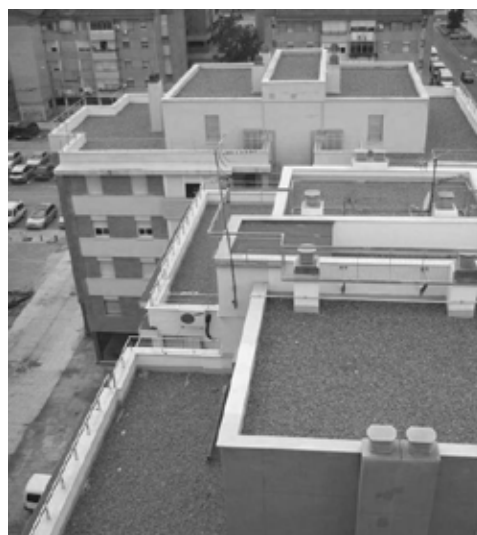
255] Estado final tras la intervención. Trasteros en cubierta y taquimotos. Fotos: Surco Arquitectura.
