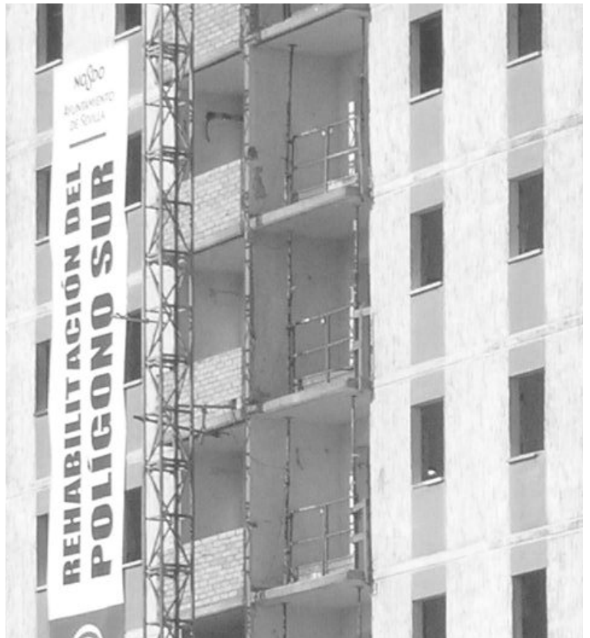
1] Bloque de vivienda social en rehabilitación en el Polígono Sur de Sevilla. Foto: Surco Arquitectura.
