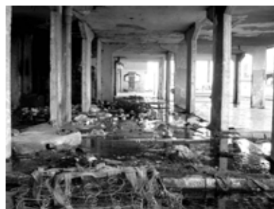
236] Imágenes de la precariedad que llegó a alcanzar el espacio colectivo y la edificación en algunos puntos de la barriada. Fotos: Surco (2006) y De Manuel (2004).
