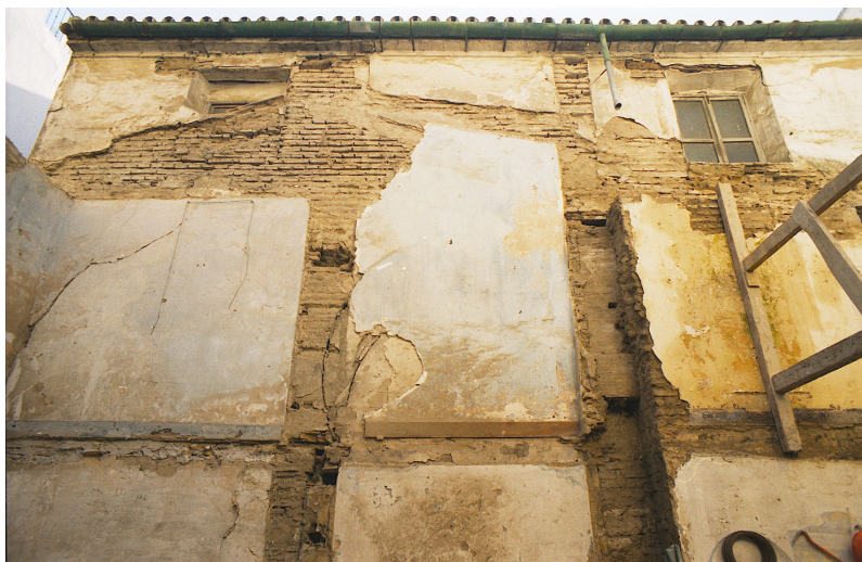
Fotografía 5. Rastro de arco en el muro de la iglesia.
