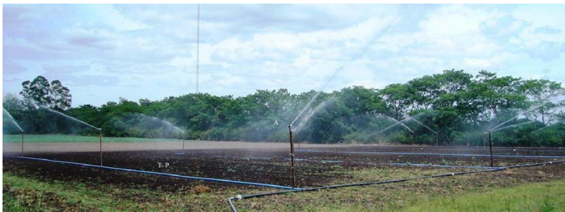
Figura III.8. Campo utilizado en la Estación Experimental “Julio Hirschhorn” EE con el sistema de riego en funcionamiento (T.P: tubo perimetral; A: Apersores).
