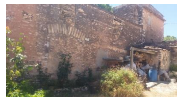
Ocupación ilegal por parte de los vecinos en la fachada oeste.
