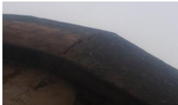
Figura 11 Patología cúpula. Fuente: Autor.
