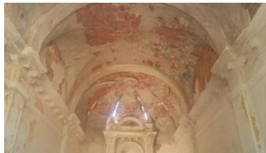
Desquebrajado de la cúpula por falta de trabado de ladrillos.
