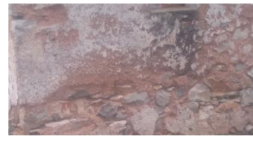
Alcance de humedades por capilaridad.
