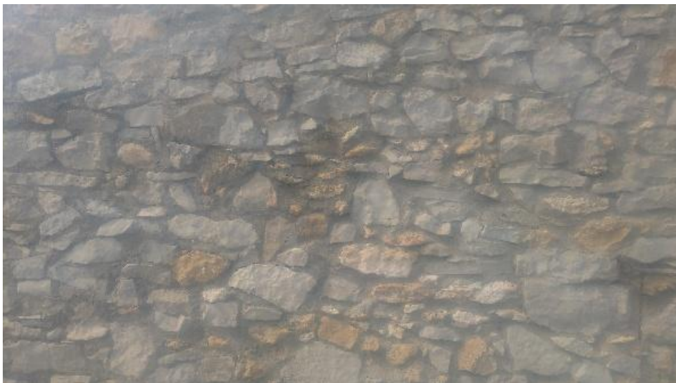
Imagen 3: Encuentro Mampostería Careada Fuente: Autor
