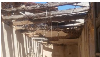
Estado de la buhardilla y cubierta de las escuelas.
