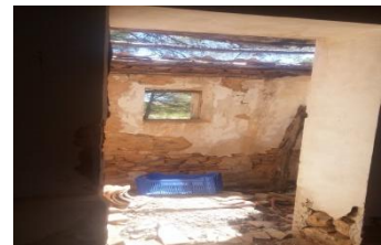
Vistas de patología en el cuarto de la ermita.
