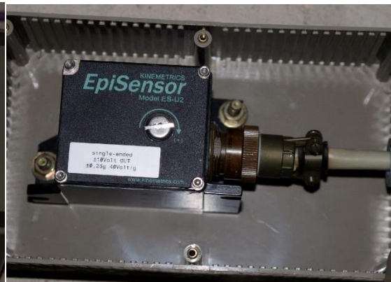
Figura 4.15 – Acelerómetro instalado na obra [72]
