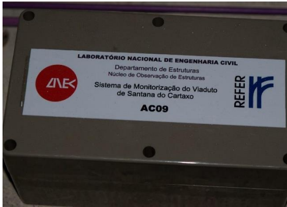
Figura 4.14 – Caixa de proteção do acelerómetro instalado na obra [72]
