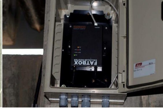
Figura 4.13 – Router para ligação à Internet [72]
