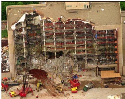
Figura 1.1: Destruição do edifício federal em Oklahoma City. [36]
