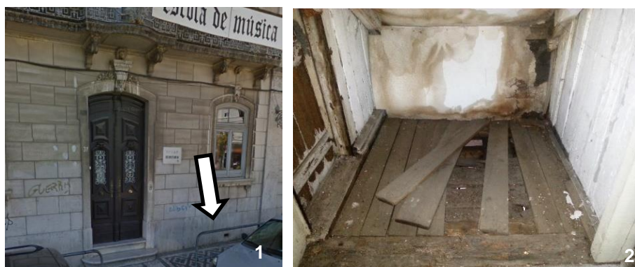
1-Ventiladores no piso térreo do Palácio António José Gomes, Cova da Piedade; 2- Pavimento em madeira com vigas e tarugos, Palacete de Odivelas, Lisboa
