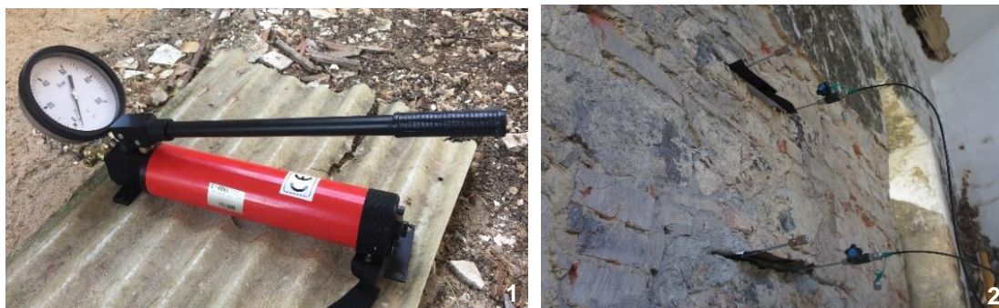
1-Bomba hidráulica manual com manómetro; 2- Aspecto final da disposição de equipamentos
