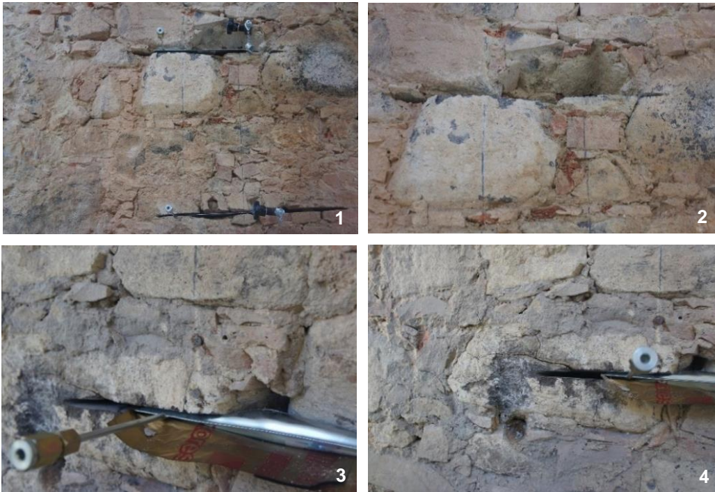
1-Janela E3 com área de contacto comprometida; 2- Pormenor de E3; 3, 4- Deformação da parede e dos macacos
