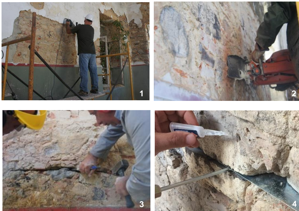
1-Picagem do reboco; 2- Cortes horizontais com a máquina de corte; 3- Retirar material solto; 4- Colagem das miras
