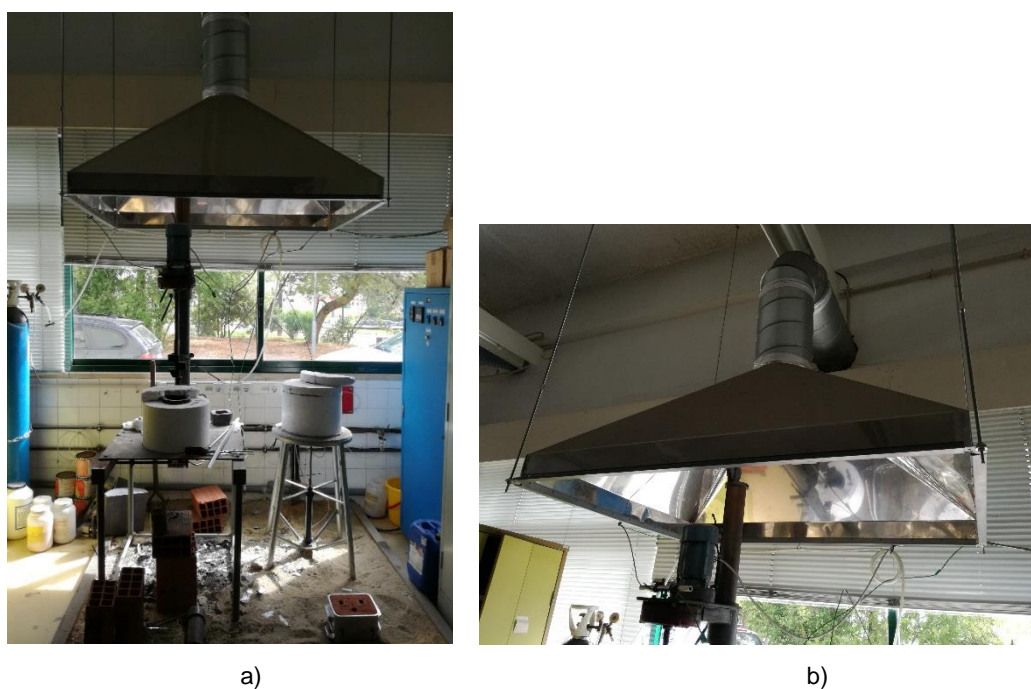
Figura 13 - Sistema de escoamento de gases instalado no laboratório de fundição do CENIMAT. a) Vista geral; b) Vista em pormenor.
