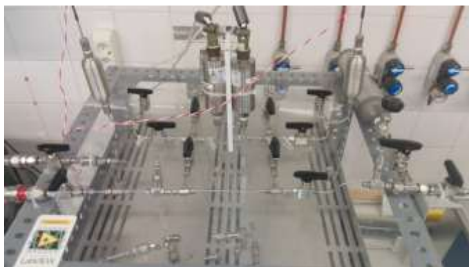
Figura 3.7 Unidade volumétrica - sistema de tubagens e válvulas.
