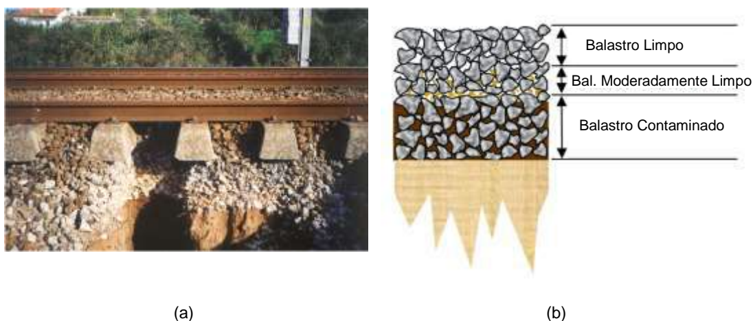
Figura 2.4 Aspeto geral de uma via-férrea com contaminação (a) e uma secção típica da camada de balastro (b), adaptado [10] [2]
