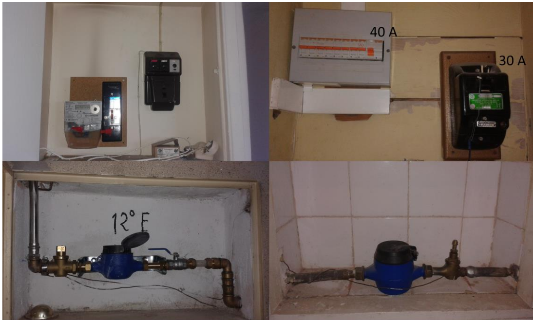
Figura 1.8 - Exemplos de instalações elétricas desatualizadas
