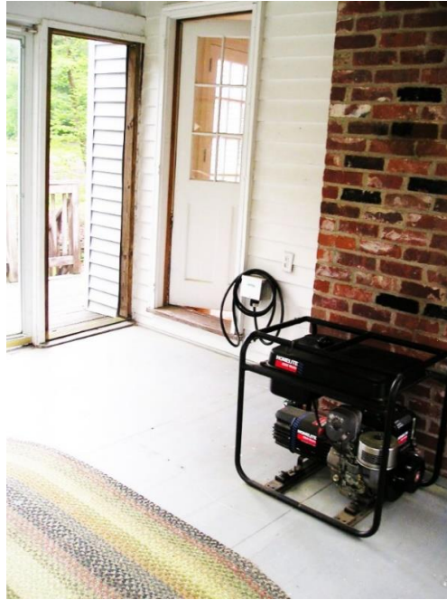
Figura 1.4 - Gerador instalado numa habitação
