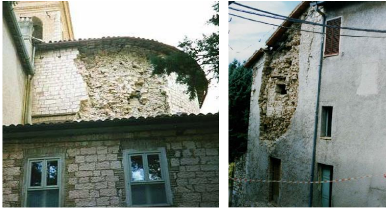
Figura 2.20 – Destacamento do paramento exterior por desagregação [43]
