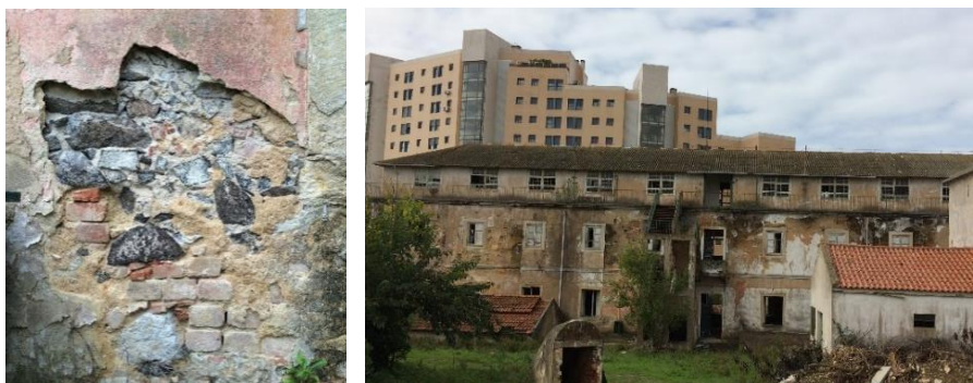
Figura 2.19 – Desagregação da fachada exterior de um edifício em Lisboa
