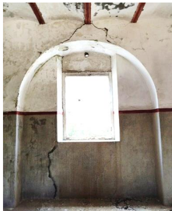
Figura 2.21 – Fendilhação numa parede resistente
