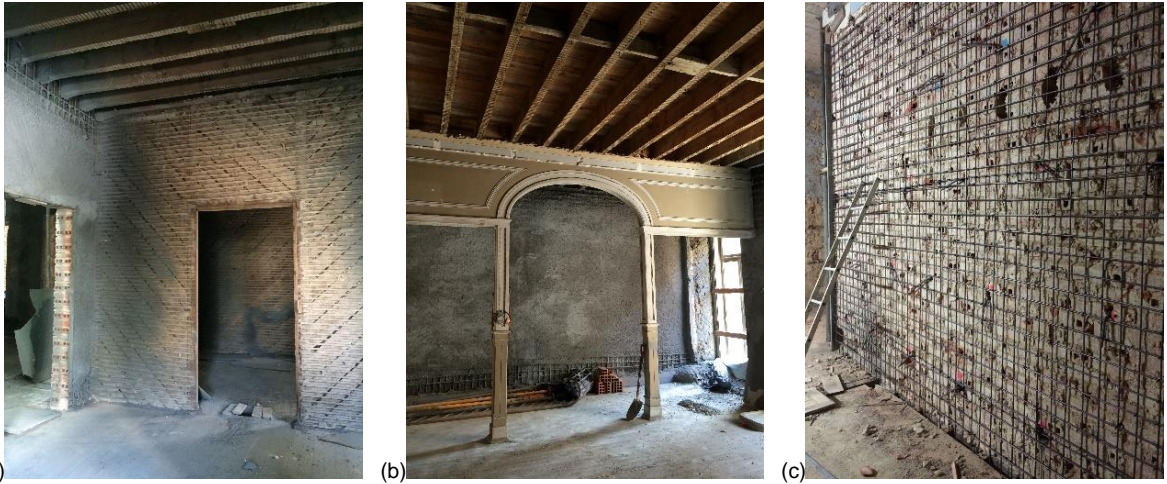
(a) – Parede de alvenaria de tijolo com a lâmina aplicada e tabique adjacente; (b) – Elementos decorativos mantidos; (c) – Armadura preparada para a aplicação da lâmina de microbetão
