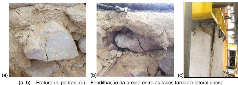
Figura 5.5 – Danos do murete
