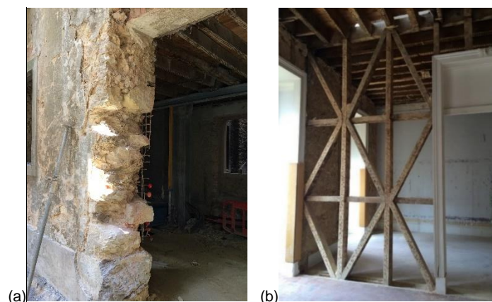
(a) – Parede mestra; (b) – Estrutura em cruz de Sto. André Figura 2.3 – Estrutura de paredes mestras de alvenaria de pedra
