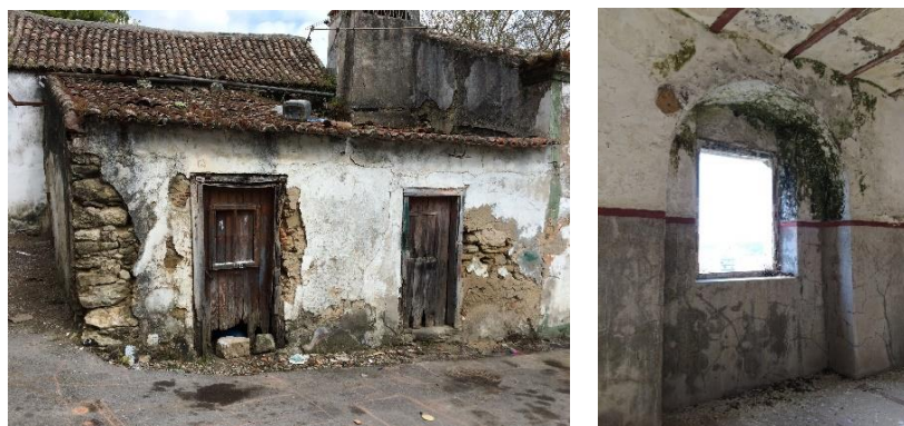
Figura 2.23 – Ação da água como fator de deterioração
