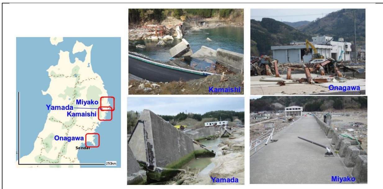
Figura 39 – Danos em diques e instalações portuárias devido ao tsunami Fonte: Government of Japan, 2011 b), p. III-26
