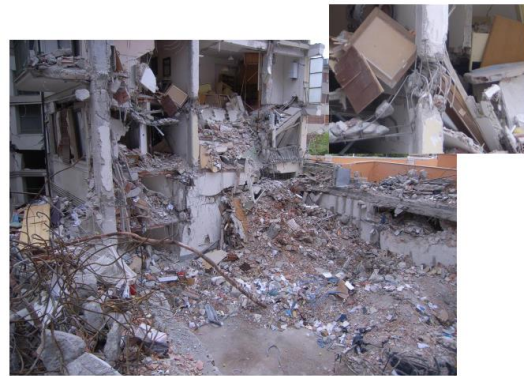
d) – Colapso de edifício de betão armado
