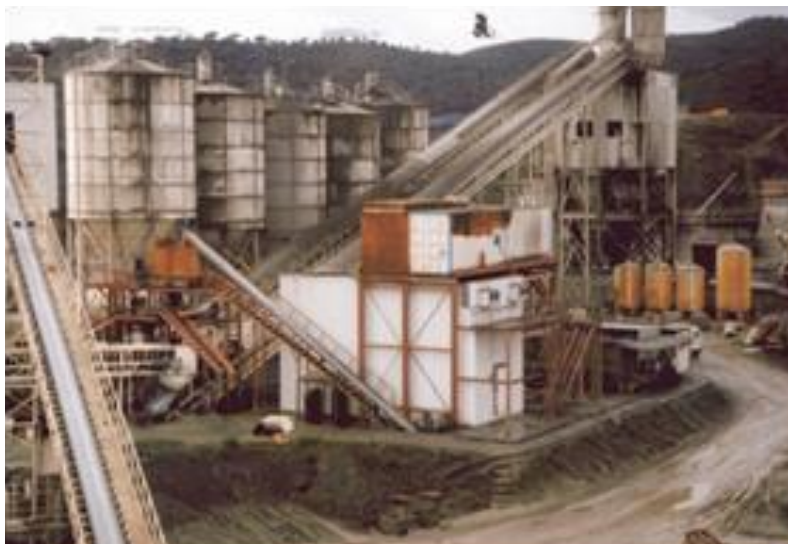
Figura 5.4 - Central de produção de escamas de gelo na construção da Barragem de Alqueva
