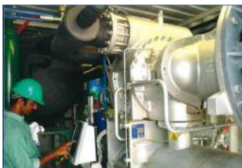
Figura 5.2 - Central de arrefecimento de água (KTI, 2011)
