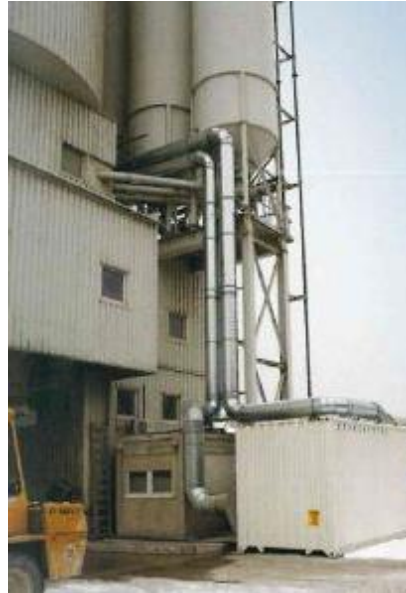
Figura 5.14 - Central de arrefecimento de agregados grossos – silos de arrefecimento por ar frio (KTI, 2011)
