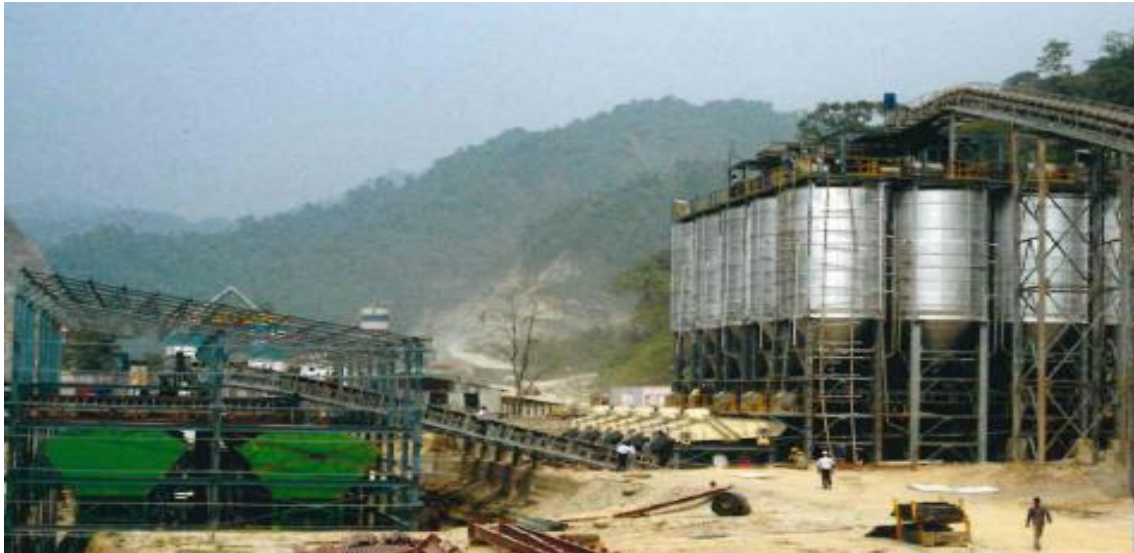
Figura 5.12 - Silos de Inundação (KTI, 2011)
