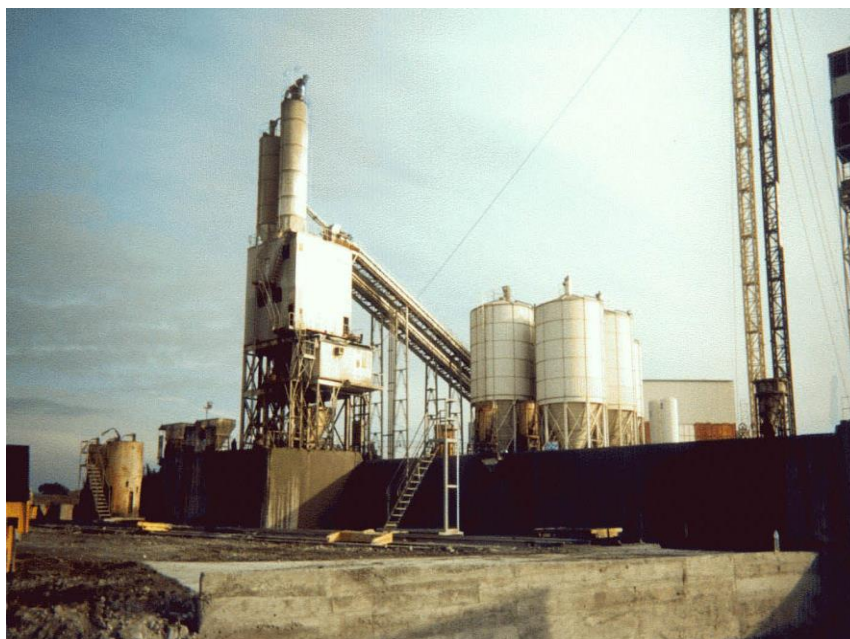
Figura 3.2 – Central de produção de betão (Barragem de Alqueva)
