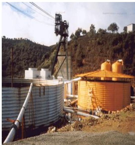
Figura 6.7 - Depósitos de água associados a uma central de pós-refrigeração
