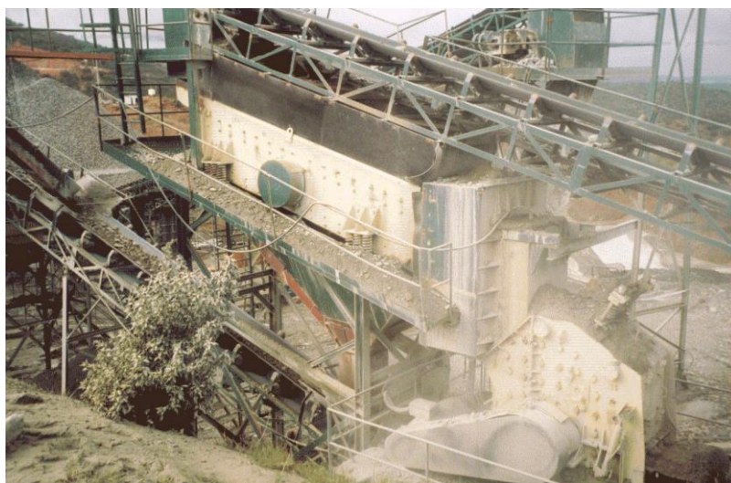
Figura 3.4 – Equipamento de britagem de agregados
