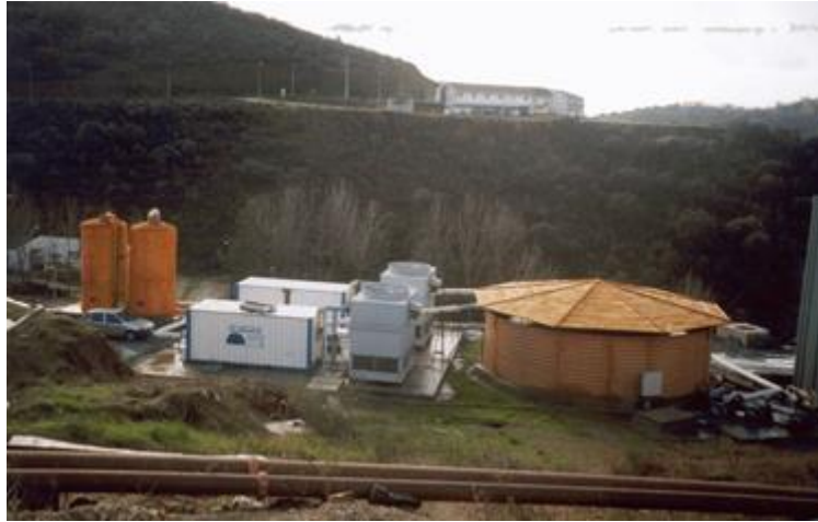
Figura 6.6 - Central de pós-refrigeração (margem direita, Barragem de Alqueva)
