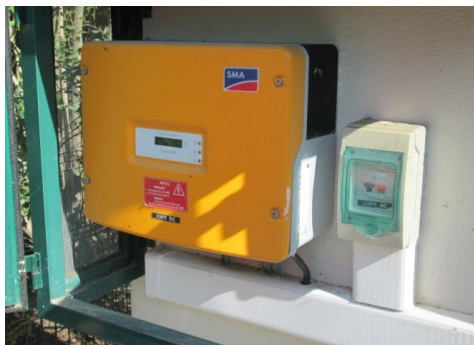
Figura 2 - Componentes de microgeração inversor e contador.
