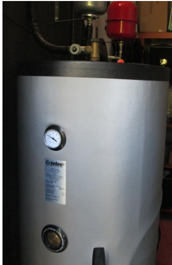
Figura 4 - Depósito para armazenamento de águas quentes de 200 litros.
