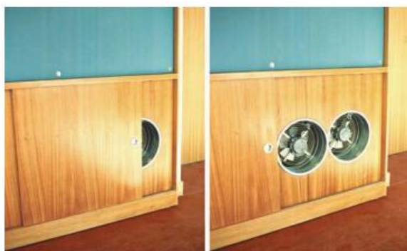
Figura 8 - Saídas de ventilação no interior das salas, (INETI, 2005).
