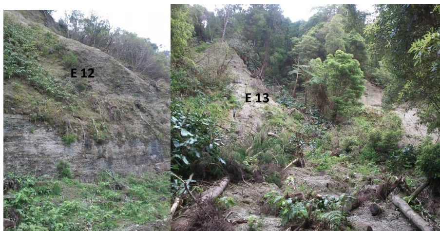
Figura 4.18 - Escorregamentos no final do caminho do trilho próximo da estrada regional a E (10/01/14)
