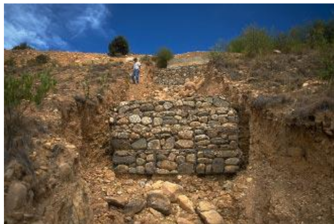
Figura 3.21 - Falha numa estrutura de controlo, construída em gabião para o controlo de uma ravina (Keller & Sherar, 2003)
