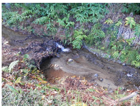
Figura 5.9 - Bacia de retenção (destruída) ao longo da Ribeira do Rosal, a sul da Lagoa das Furnas (19/12/13)
