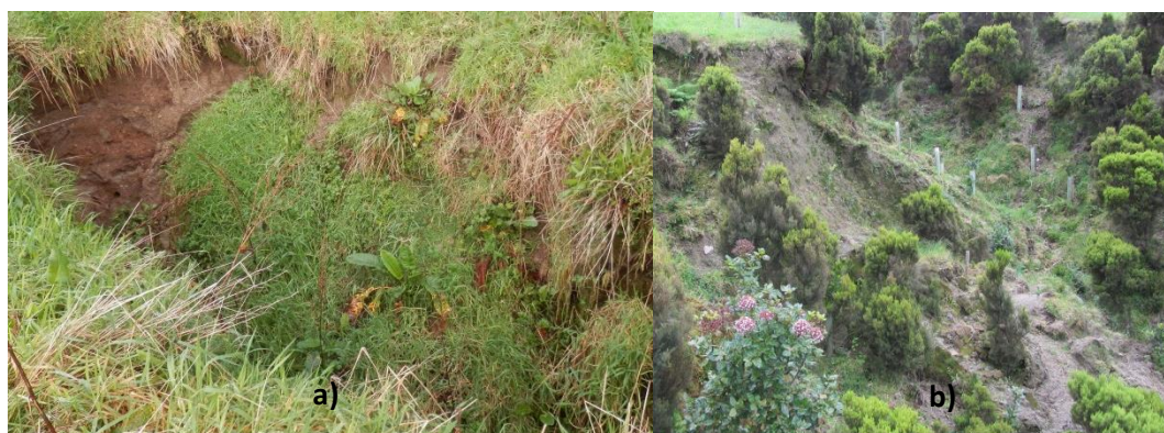
Figura 4.19 - Escorregamentos nas margens das ravinas/barrancos. a) RB 1; b) RB 11 (10/01/14)
