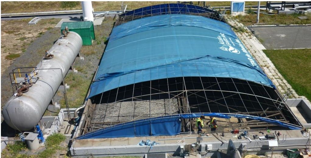
Figura 4.5 – Vista aérea dos dois TROG, estando um deles em manutenção
