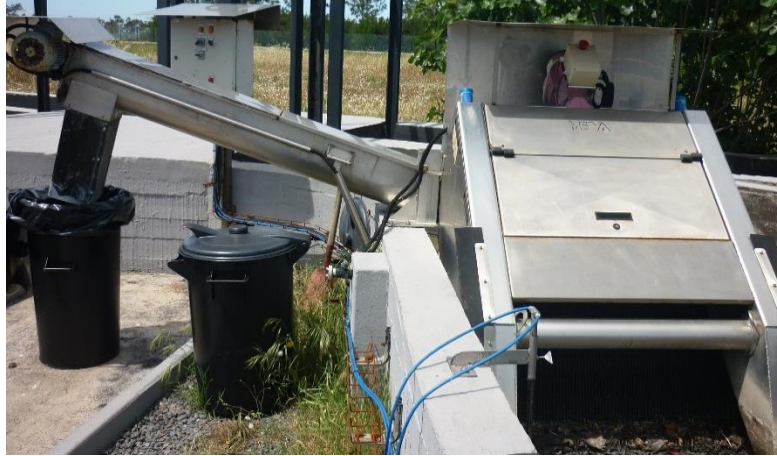
Figura 4.4 – Step-screen e respectivo parafuso compactador
