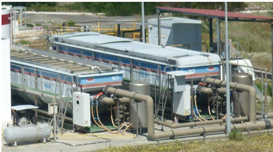
Figura 4.11 – Vista aérea dos dois flotadores por ar dissolvido
