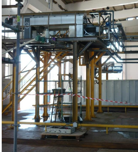
Figura 4.13 – Vista lateral de uma das centrífugas no edifício da desidratação
