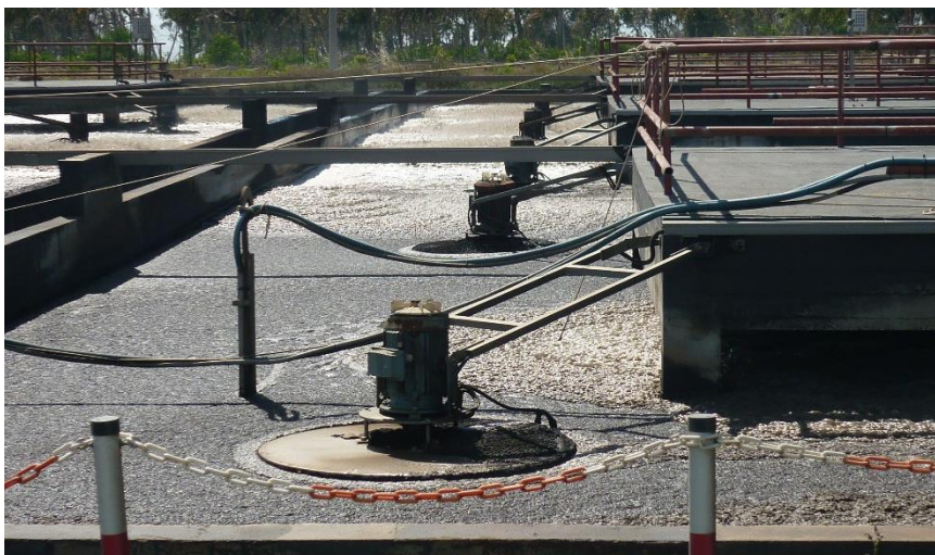
Figura 4.9 – Vista parcial do reactor biológico
