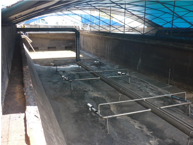
Figura 4.6 – Vista interior de parte de um TROG em manutenção com 6 hidrojéctores visíveis
