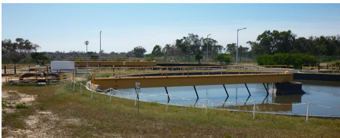
Figura 4.10 – Vista geral de um dos decantadores secundários
