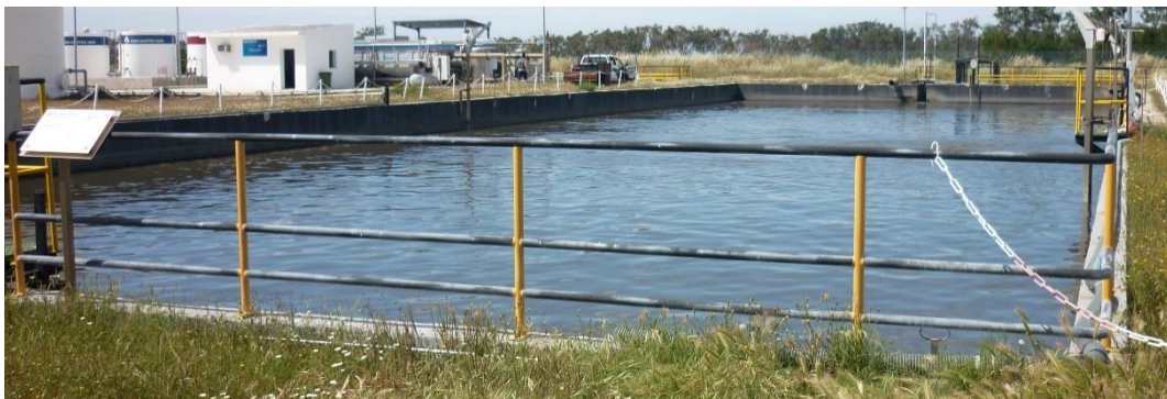
Figura 4.7 – Tanque de homogeneização
