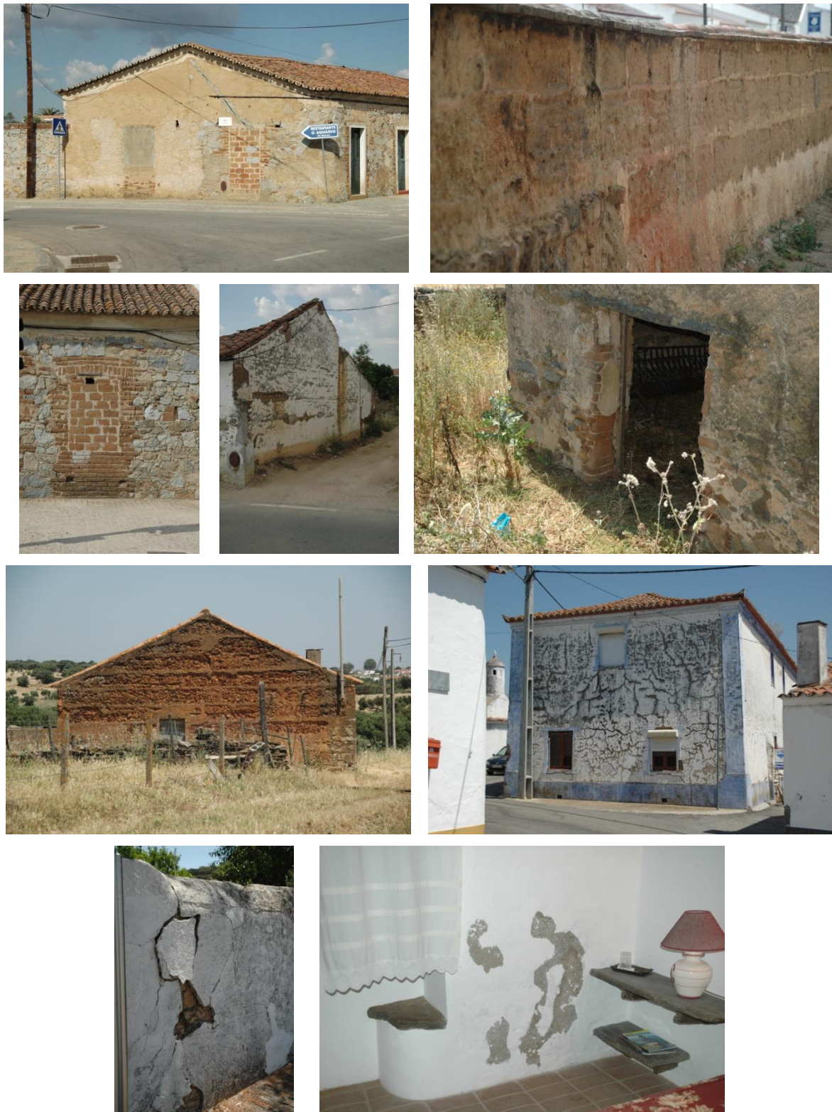
Figura 2.3 – a) b) c) d) e) f) Degradação dos rebocos em construções de terra; g) h) Problemas decorrentes da aplicação de argamassas exteriores de cal e cimento sobre construções de terra; i) Problemas decorrentes da aplicação de argamassas de reboco interior em construções de terra
