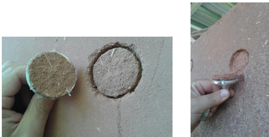
Figura 8.51 – Rotura na interface pastilha/argamassa (à esq.); Rotura na interface argamassa/suporte (à dir.)
