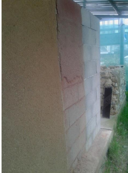
Figura 7.7 – Degradação da argamassa de terra no lado Sul dos muretes
