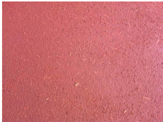
Figura 7.5 – Observação visual do reboco aplicado num dos muretes de alvenaria - cor, textura e presença das fibras vegetais [Faria et al., 2014]
