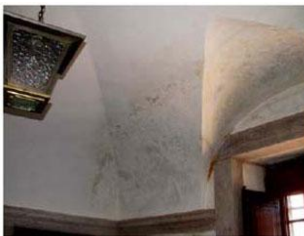
Figura 2.25 - Degradação devido a infiltração de água de precipitação através dos tectos [40].
