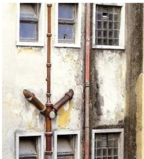
Figura 2.27 - Edifício com canalizações exterior de drenagem de águas degradadas [38].
