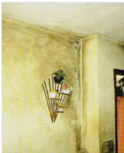
Figura 2.26 - Bolores em parede devido a condensações [27].
