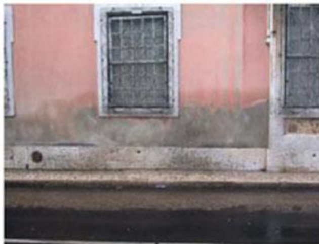
Figura 2.24 - Manchas de humidade devidas a ascensão por capilaridade [40].
