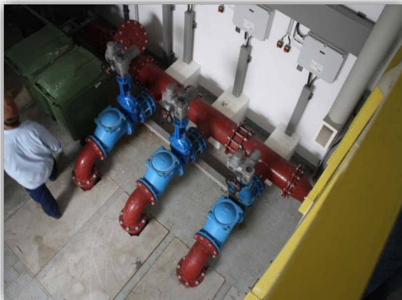
Figura 3.5 – Vista da câmara de manobras da instalação elevatória EE7
