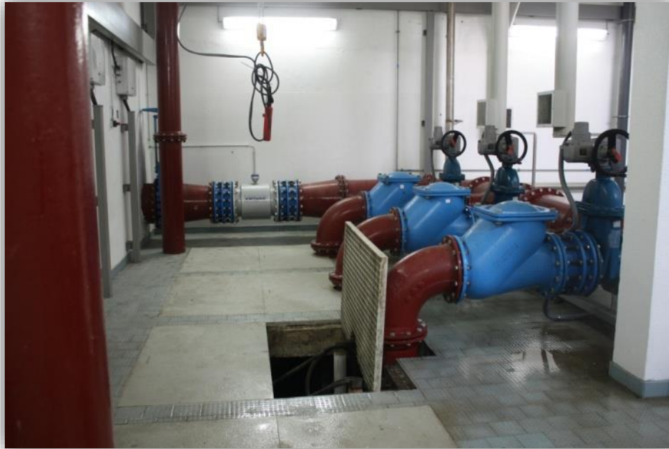
Figura 3.7 – Vista da câmara de manobras da instalação elevatória EE8
