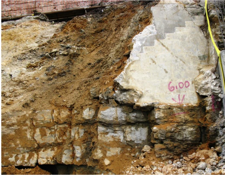
Figura 4.21: Lado Sul da zona de rotura, observa-se muito bem a compartimentação do maciço calcário
