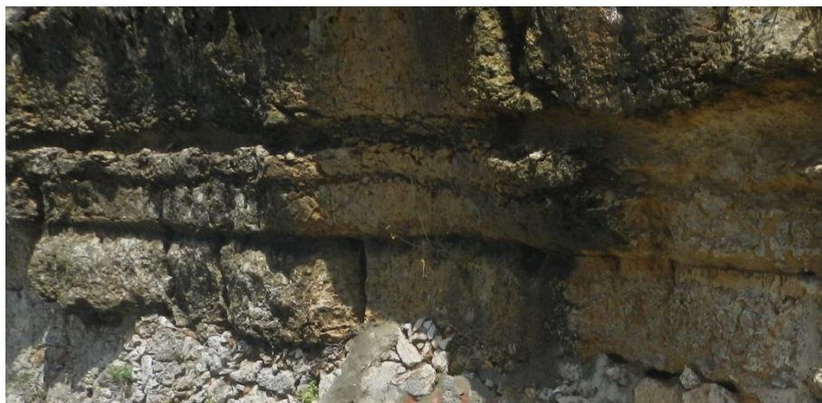
Figura 3.24: Pormenor de erosão diferencial
