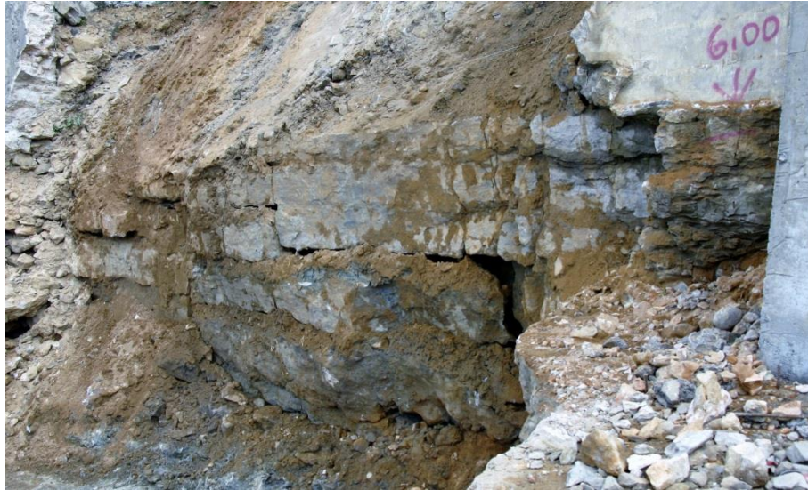
Figura 4.14: Condições das camadas subjacentes ao muro de suporte original, as camadas superiores ainda se encontram in situ , enquanto que as inferiores se encontram abatidas no sentido do mar, indiciando a perda das margas que as intercalavam
