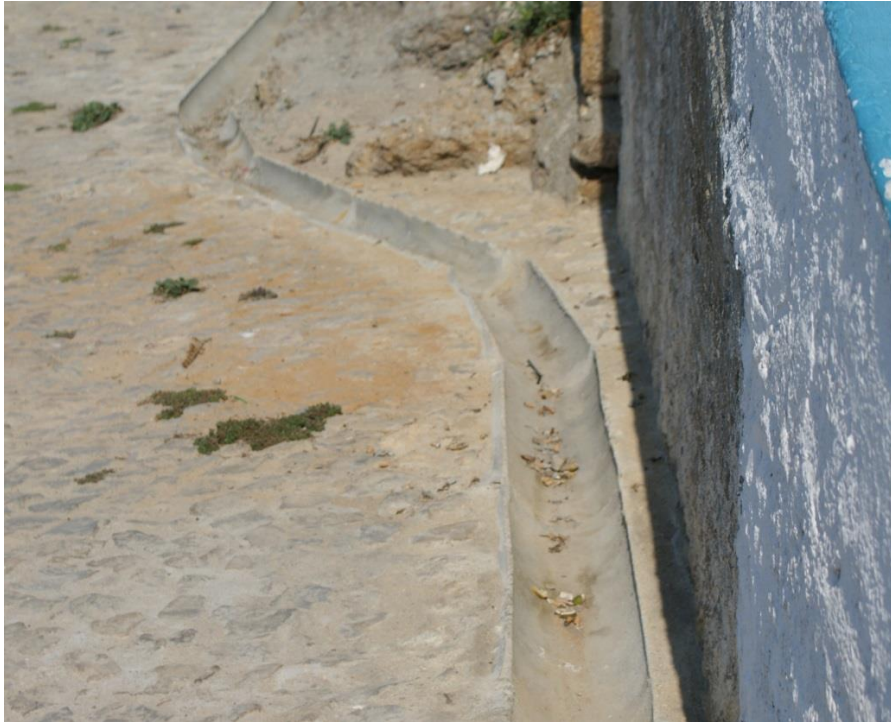
Figura 4.42: Sistema de drenagem em meia cana paralelo a toda a laje da rampa
