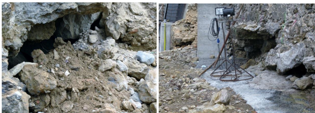
Figura 4.40: Pormenor de cavidades de grandes dimensões no sopé do muro original
