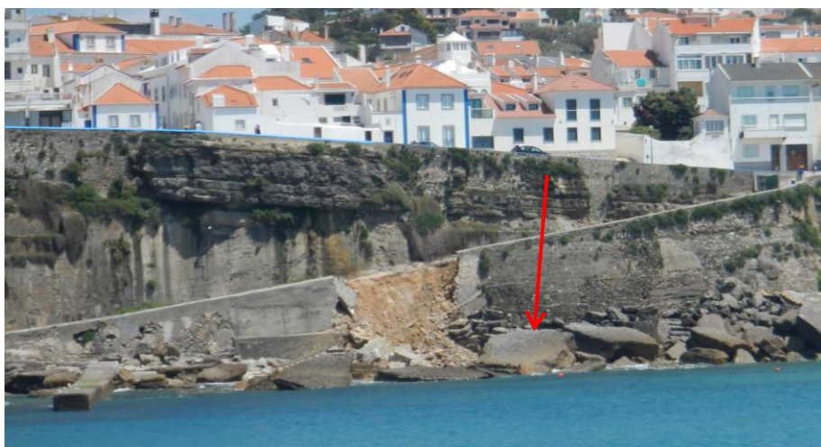
Figura 3.18: imagem do muro após o seu rompimento
