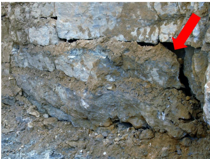
Figura 4.16: Bloco central basculado no sentido do mar, devido à falta de sustentação por perda das intercalações margosas, erodidas pela ação do mar na zona rompida do muro
