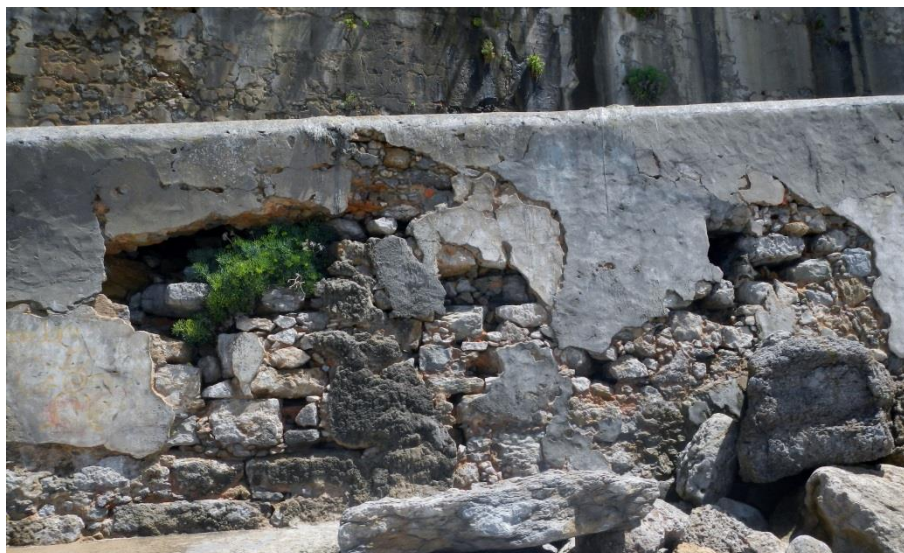
Figura 3.30: Muro de contenção original em estado muito alterado ou mesmo ausente em algumas porções, após a rotura
