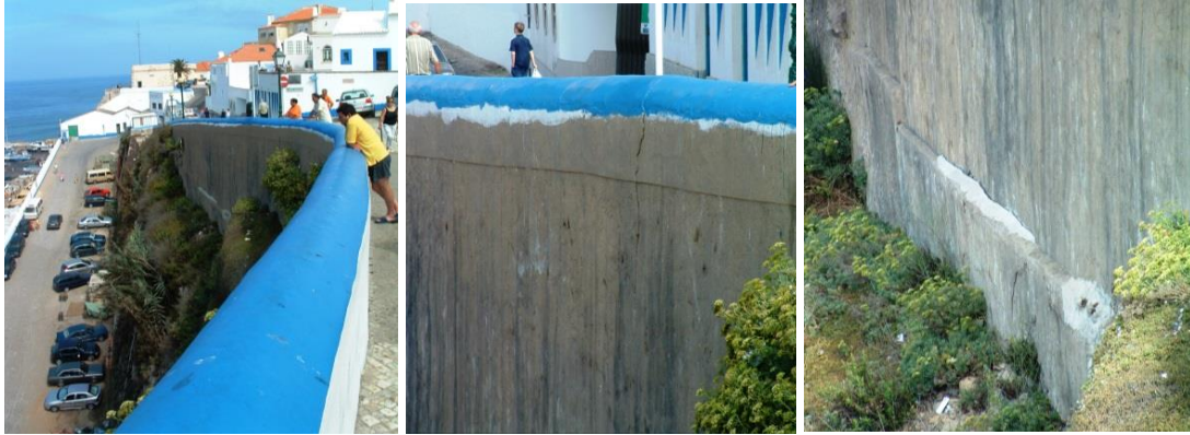
Figura 3.10: Muro que suporta o topo da arriba sobre a praia dos Pescadores, e pormenores de fissuração no muro
