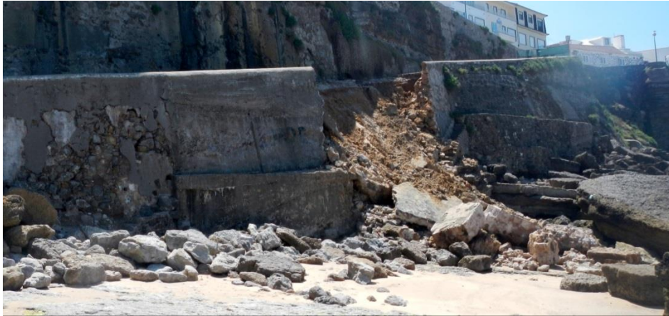
Figura 4.7: Blocos rochosos sob o muro, que funcionavam como quebra-mar natural
