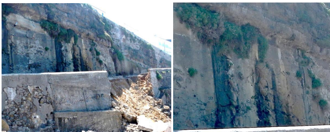
Figura 3.26: Escorrência de água na arriba e vegetação resultante
