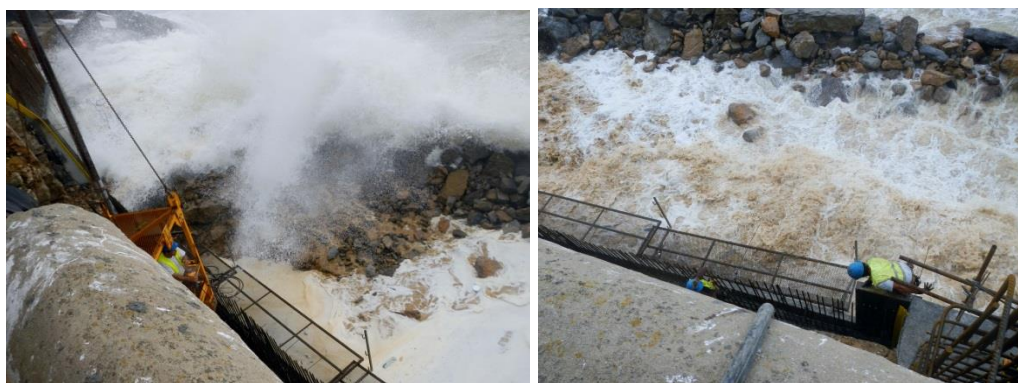
Figura 4.28: Marés vivas a atingir a fundação do muro de contenção, impedindo o acesso ao local por parte dos trabalhadores e das máquinas
