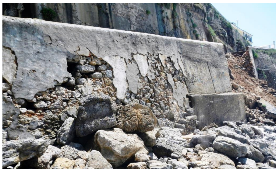
Figura 3.20: Muro de contenção original revestido por cimento muito alterado, evidenciando os blocos constituintes do muro e o seu desmoronamento em troços de dimensões consideráveis
