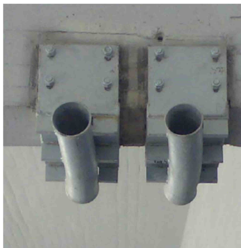
Figura 3.89 – Vista frontal da sela de desvio.
