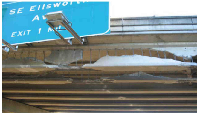
Figura 2.14 – Viga danificada (Khaleghi).
