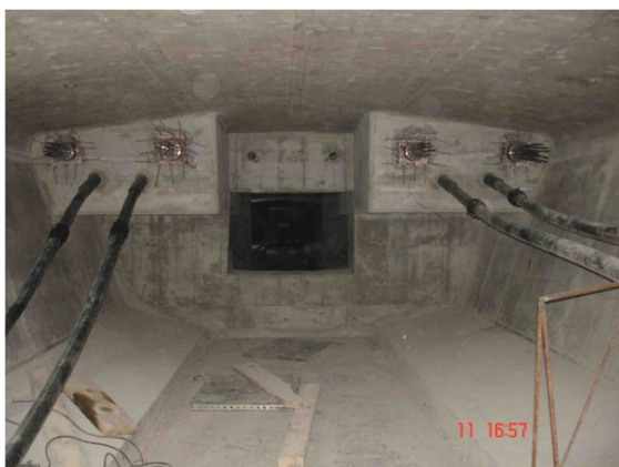
Figura 3.76 – Ancoragens e cabos.
