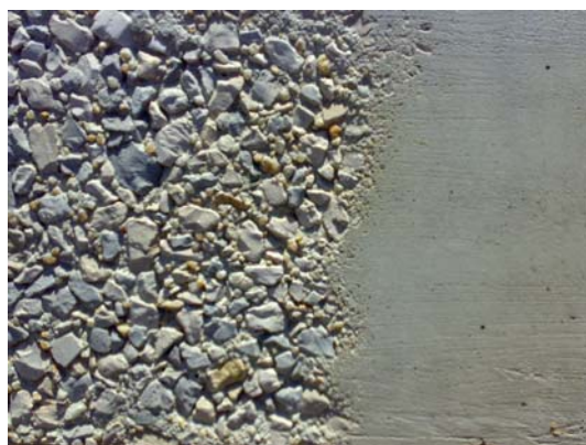
Figura 3.5: Pormenor da diferença entre a superfície de betão tratada com jacto de areia e a superfície de betão inicial.
