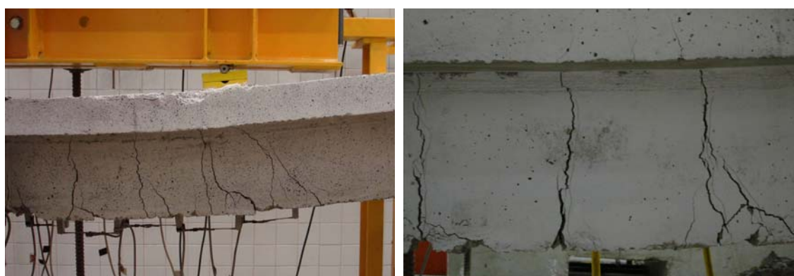
Figura 6.32: Fendilhação observada na viga sob carregamento cíclico após a descolagem do compósito de GFRP.
