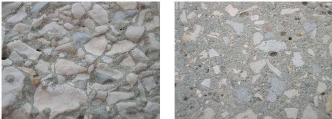
Figura 2.31: Tratamento de superfície com aplicação exagerada de jacto de areia (à esquerda) e com aplicação apenas para tirar a camada superficial de betão (à direita) [137].
