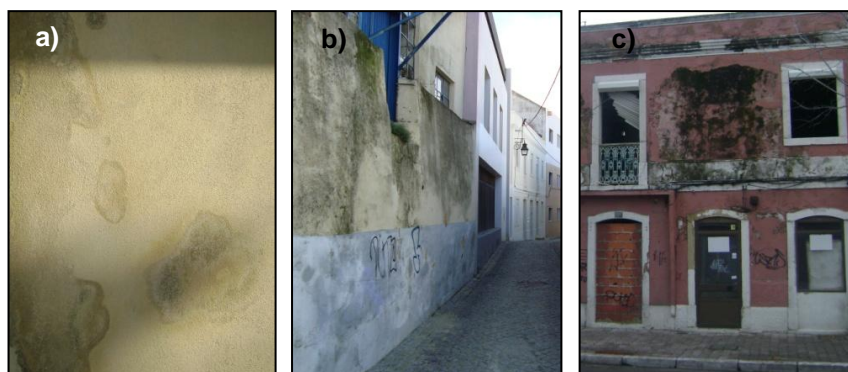
Fig. 1.1 - Exemplos de anomalias em revestimentos: a) Manchas de humidade; b) e c) Manchas de humidade e biodeterioração (fotografias a) e c) de Débora Fernandes)
