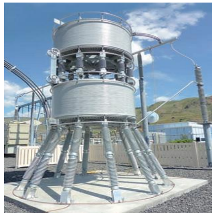
Figura 2.16 – Reator de núcleo de ar da Alstom.
