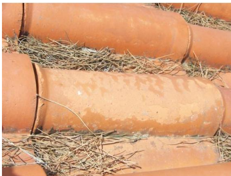
Figura 4.4 – Escamação em telha (Adaptado de Garcez, 2009).
