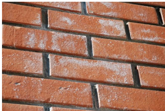
Figura 4.12 – Eflorescências em ladrilhos cerâmicos.
