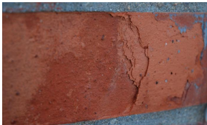
Figura 4.5 – Lascagem em ladrilho cerâmico.
