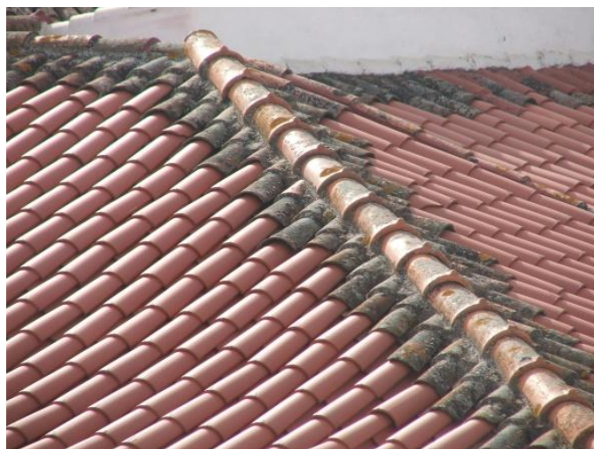
Figura 4.16 - Reparação em telhado cerâmico esteticamente mal sucedida.
