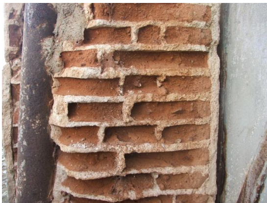
Figura 4.6 –Desagregação granular de tijolos cerâmicos.
