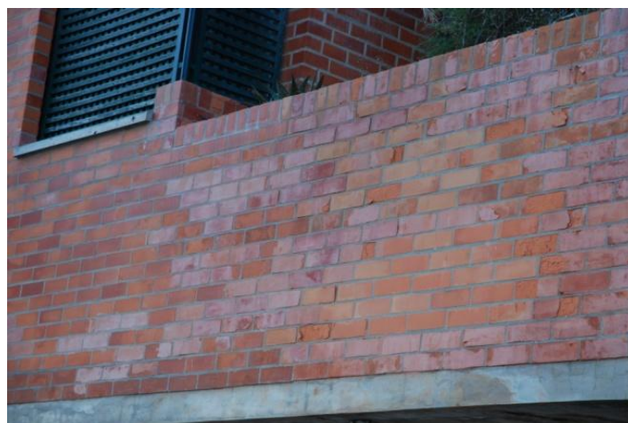
Figura 4.11 – Alteração cromática de revestimento cerâmico.
