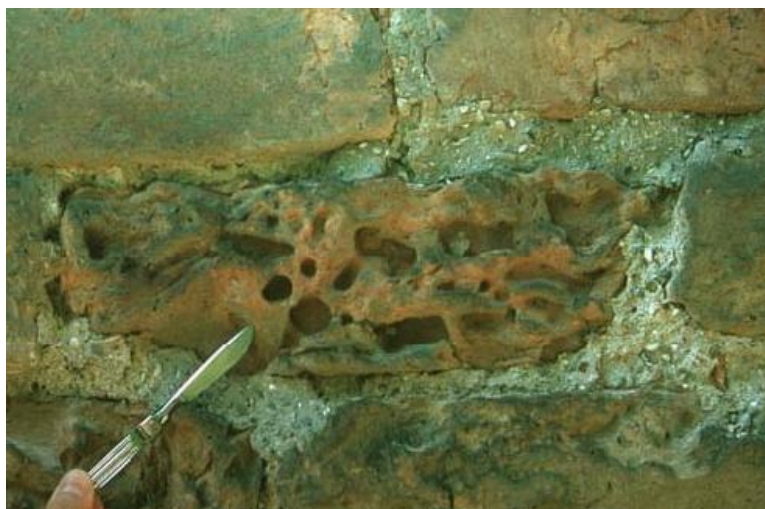
Figura 4.7 – Alveolização de tijolos cerâmicos (UNI 11182, 2006).
