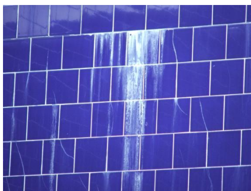
Figura 4.9 – Mancha em azulejos cerâmicos.
