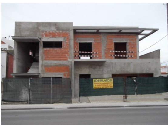
Figura 67 – Edifício a ser construído para serviços na Avenida Principal (2011) (para substituir o edifício da Figura 65). Fonte: Autor
