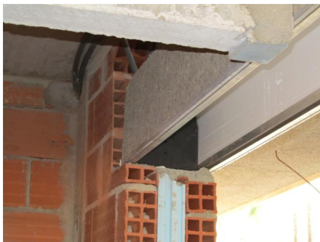
Figura 2.b - Vista pelo interior sobre uma zona de ligação da parede exterior com caixa - de - estore
