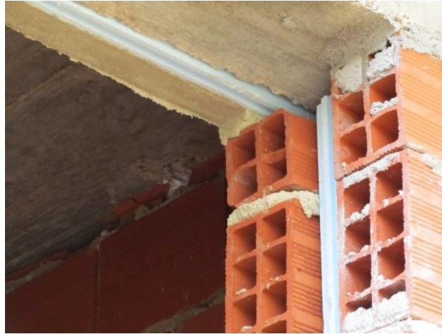
Figura 3.a - Vista pelo exterior sobre o elemento estrutural viga e a parede exterior
