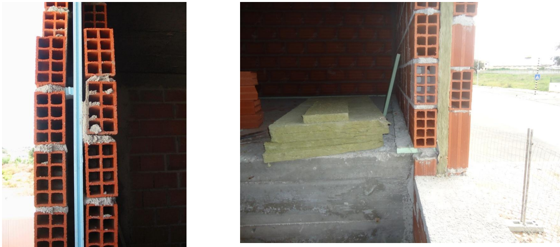
Figura 3.2 - Pormenores construtivos de uma parede dupla e uma parede de pano duplo, respectivamente
