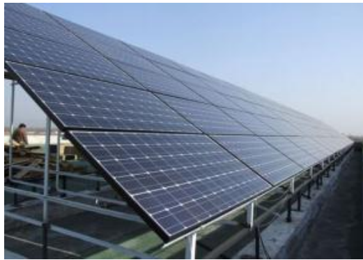
Figura 2.12 Painel de células fotovoltaicas
