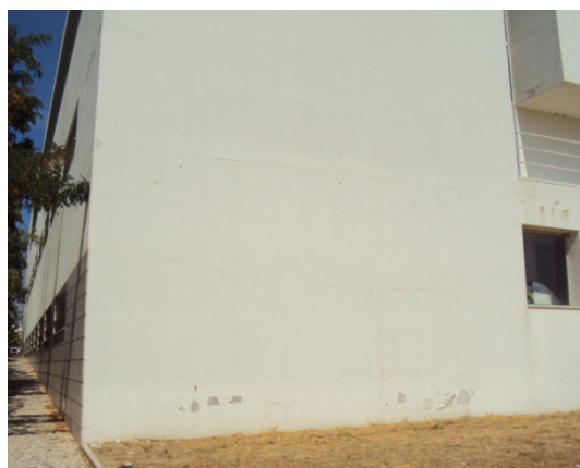
Figura 42 - Fachada do Edifício VII – Ponte térmica linear de ligação da fachada com o pavimento do piso intermédio e ligação entre as duas fachadas – Cunhal.
