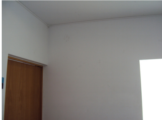
Figura 52 - Ponte térmica linear demonstrativa da ligação da fachada com o piso intermédio do Edifício X, observada pelo interior deste.
