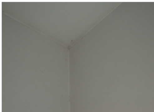
Figura 46 - Ponte térmica linear da ligação entre duas fachadas e da ligação entre o pavimento e a fachada, observada pelo interior do Edifício VII.
