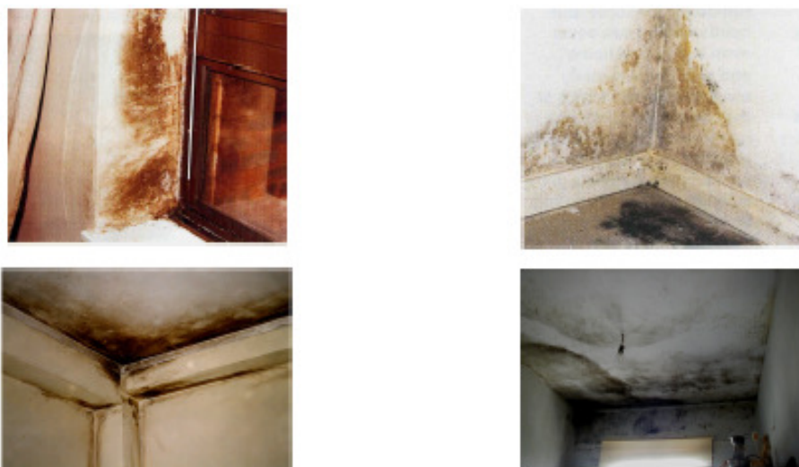
Figura 14 – Condensações e bolores na zona de pontes térmicas; fonte: (Garston, 1986).
