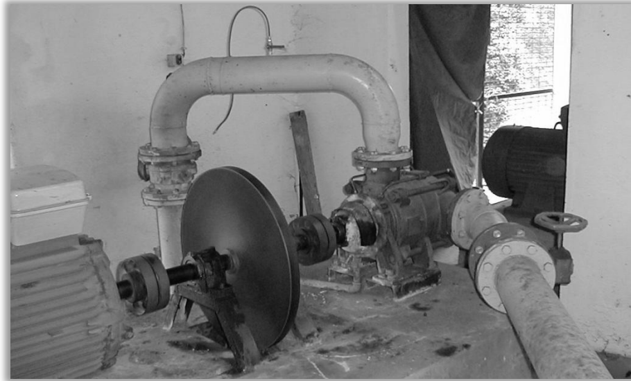
Figura 5.10. Volante de inércia instalado no veio de uma bomba (Informação académica da disciplina de Hidráulica Geral – FCT/UNL, 2006)
