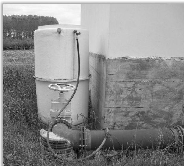
Figura 5.19. Reservatório unidireccional instalado no Sistema Elevatório 3 de Águas Residuais de Avelãs de Caminho (Cortesia de SMAS de Anadia, 2011)
