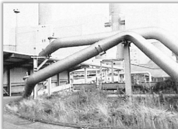
Figura 3.3. Efeitos da vibração e deslocação numa conduta elevatória DN600 (KSB, 2008)
