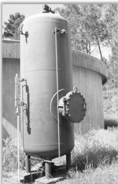
Figura 5.23. Reservatório de ar comprimido (Cortesia de Adductio, 2011)
