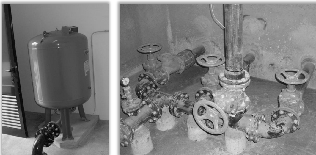
Figura 5.28. Reservatório de membrana instalado no Sistema Elevatório de Águas Residuais de Vandoma (Cortesia de Veolia-Águas de Paredes, 2011)
