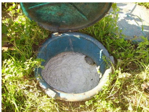
FIGURA 3.1 – FOSSA SÉPTICA DA QUEIJARIA 8
