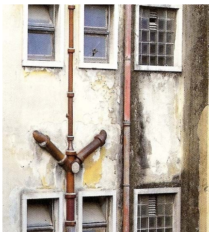
Figura 6.1 – Tardoz de edifício com canalizações de drenagem de águas residuais domésticas e pluviais, pelo exterior, degradadas [61]
