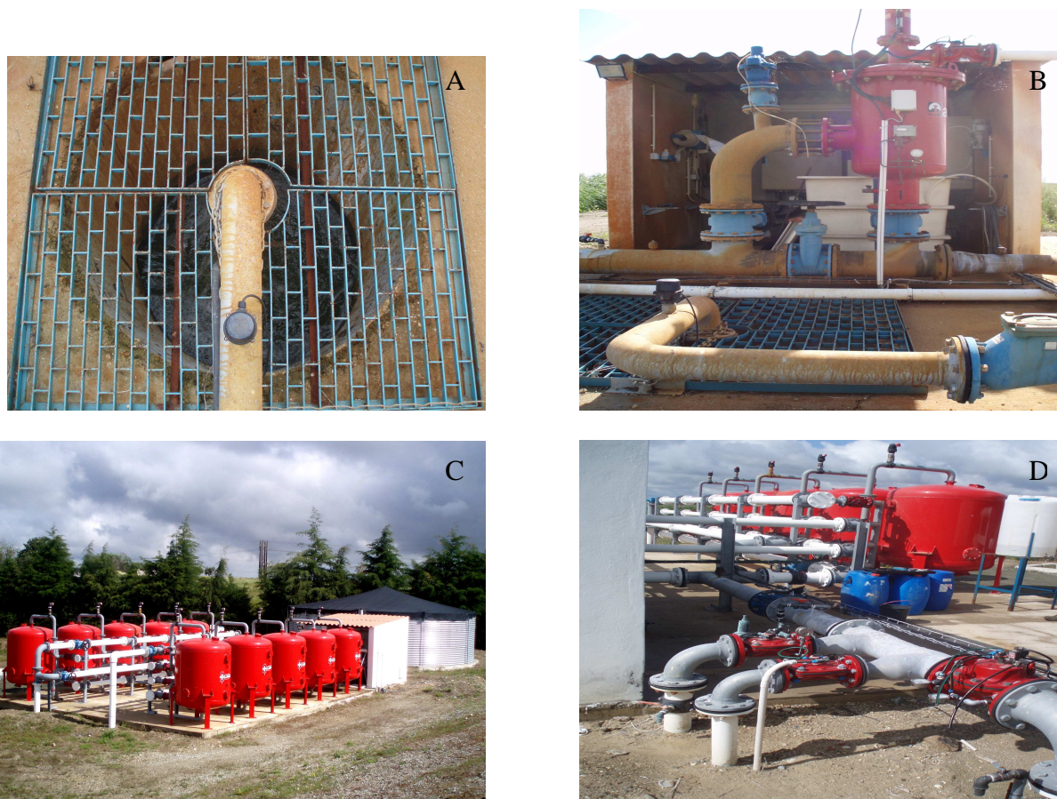
Fig 3.2: Sistema de tratamento em linha implantado e adicionado à ETAR do Sado (Out-Nov, 2005): A) bombagem (60 m 3 /h); B) pré-filtração (em by-pass) e coagulação (injecção); C) filtração leito alto (antracite e sílica); D) ponto de injecção com cloro.
