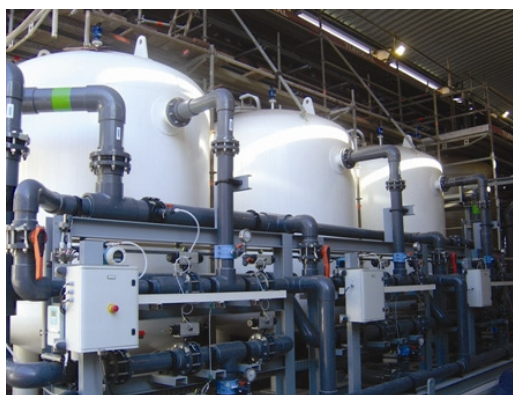
Figura 5-5 – Sistema de Osmose Inversa
