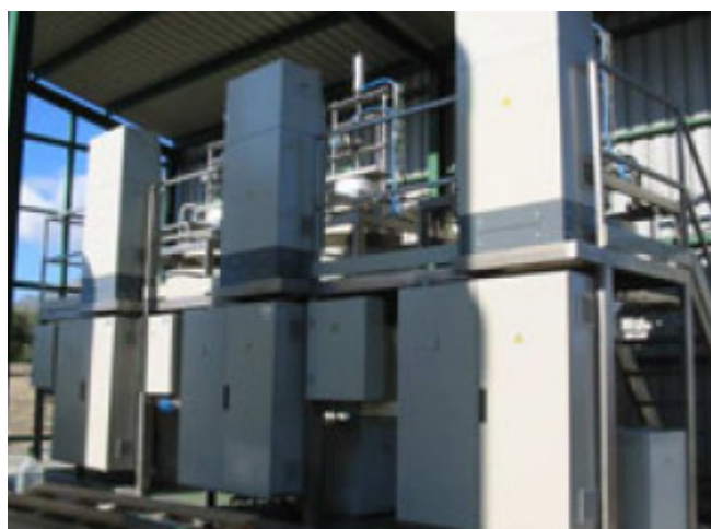
Figura 8-62 – Automatismo e Controlo
