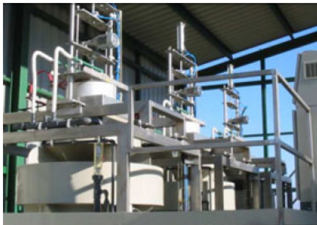
Figura 8-60 – Grupo em Linha de Reactores Electroquímicos
