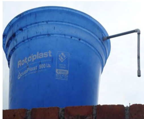
Figura 11. Tanque de Almacenamiento de Agua de 500L
