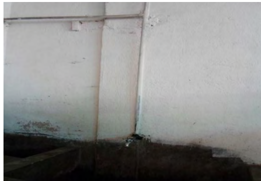
Figura 13. Tubería para transporte de agua potable con deterioro en la pintura
