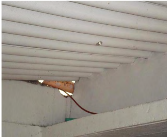
Figura 5. Teja averiada en el techo del area de procesos.
