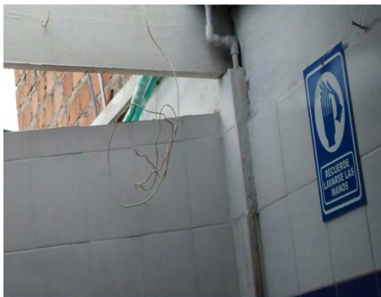
Figura 2. Abertura de gran tamaño entre una viga del techo y el limite superior de la pared en el area de empaque.
