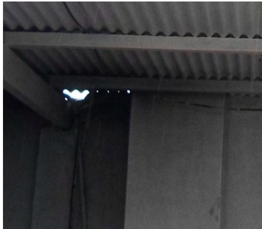
Figura 1. Agujeros entre el techo y el límite superior de las paredes en el área de proceso.
