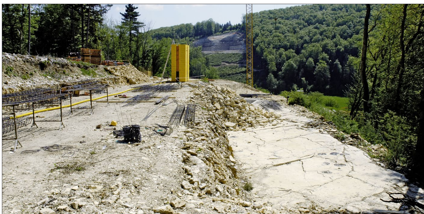
Chevezey-Crat: vue sur les secteurs 1 (à droite) et 3 (à gauche). Les piles du viaduc sont en cours de construction.
