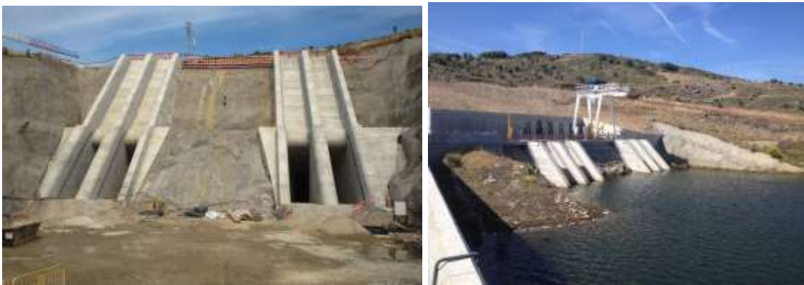
Figura 3-31 – Tomada de Água
