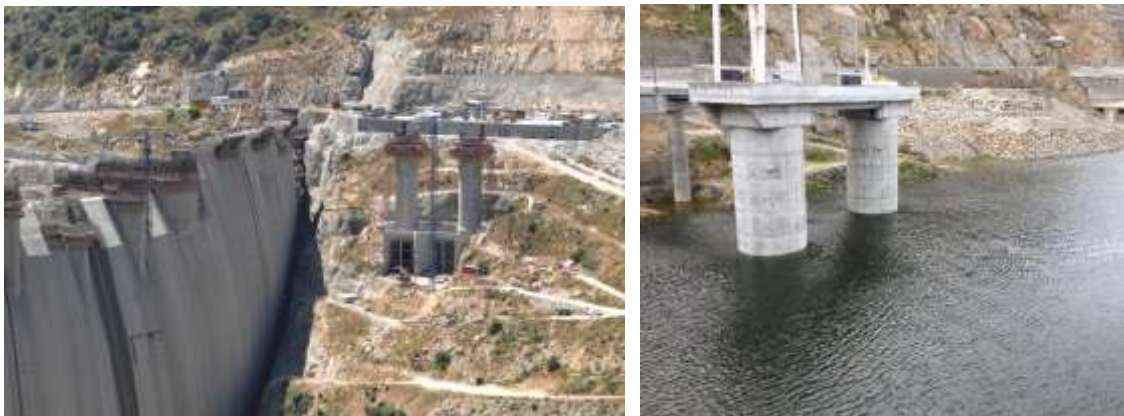
Figura 3-15 – Tomada de Água.
