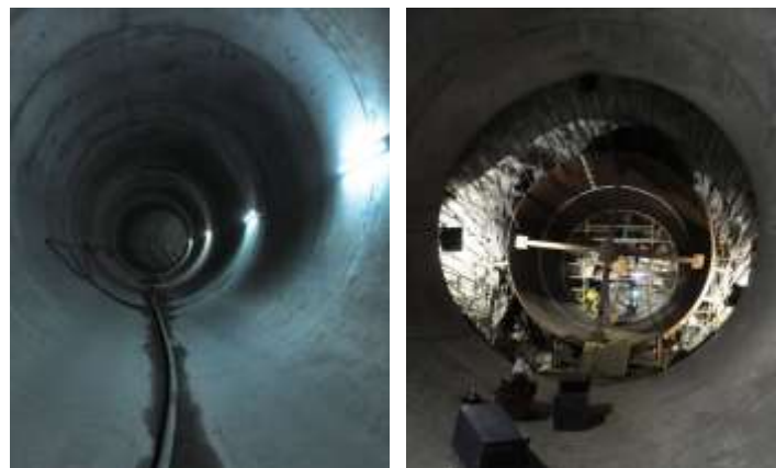
Figura 3-16 – Galerias em carga.
