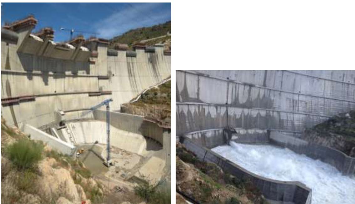
Figura 3-23 – Descarregadores de Cheias, Bacia de Dissipação e Descarga de Fundo
