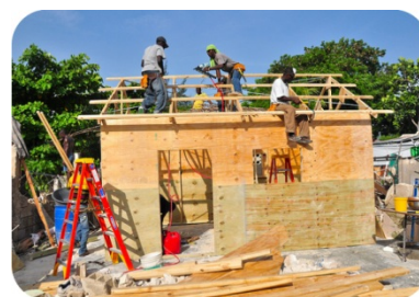
Fig. 2.14: Fase de reconstrução: um ano depois do sismo do Haiti. Fonte: US T.D. (2011).
