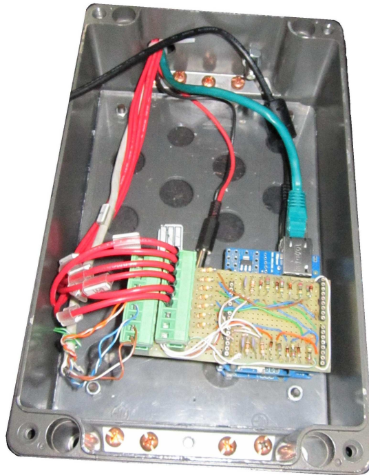
Figura 2.4: Instalação do Arduino TM responsável pela monitorização da condução.
