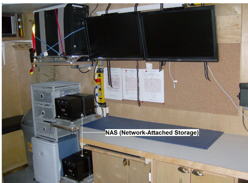
Figura 4.19- Equipamento NAS montado no interior da Dog House que é utilizado para guardar toda a informação relacionada com a aquisição.
