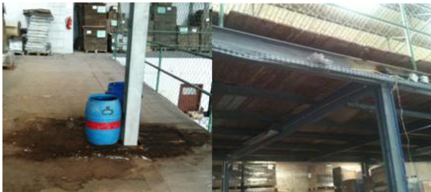
Figura 22 – Perigos do piso superior do armazém 5009
