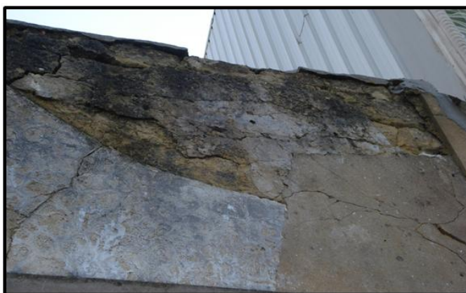
Figura 9. Degradação dos revestimentos (Matos, 2011)
