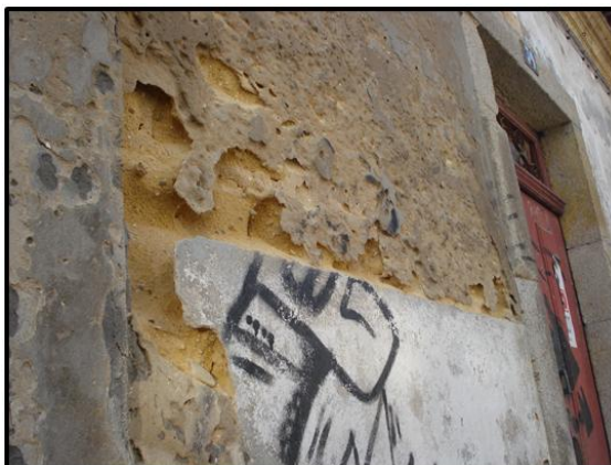
Figura 8. Degradação do adobe (Matos, 2011)
