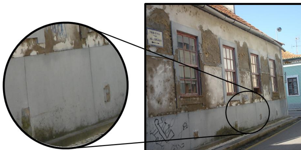
Figura 4. Fissuras nos vãos das aberturas (Matos, 2011)
