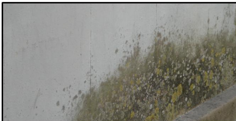
Figura 6. Manchas e humidades (Matos, 2011)
