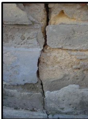
Figura 7. Fissuração na junta das paredes (Matos, 2011)
