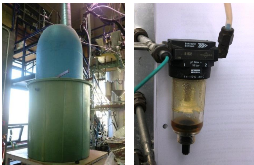
Figura 3-6 – Torre de arrefecimento do sistema de refrigeração do reator de leito fluidizado (à esquerda) sonda de amostragem com condensados (à direita).
