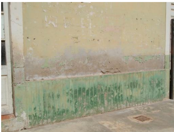
Figura 4. Eflorescências provocadas pela ascensão capilar de humidade, Liceu Velho, Mindelo São Vicente
