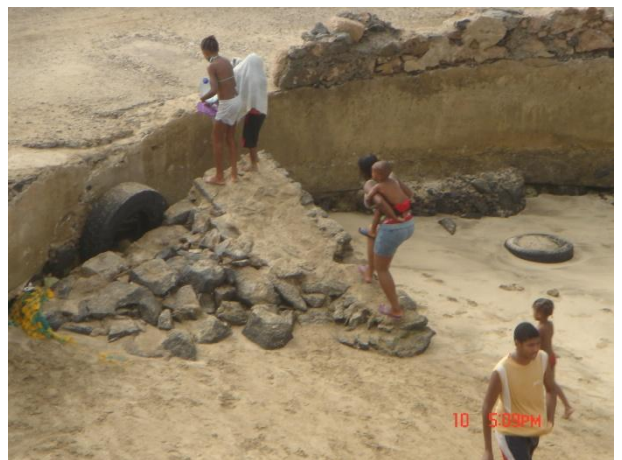
Figura 29. Bloco caído do cais do Tarrafal (CV - TR-PM3).
