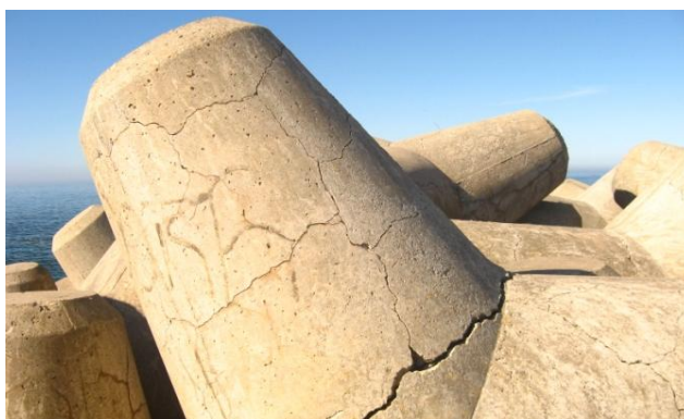
Figura 11: Exemplo de fissuração num tetrápodo.
